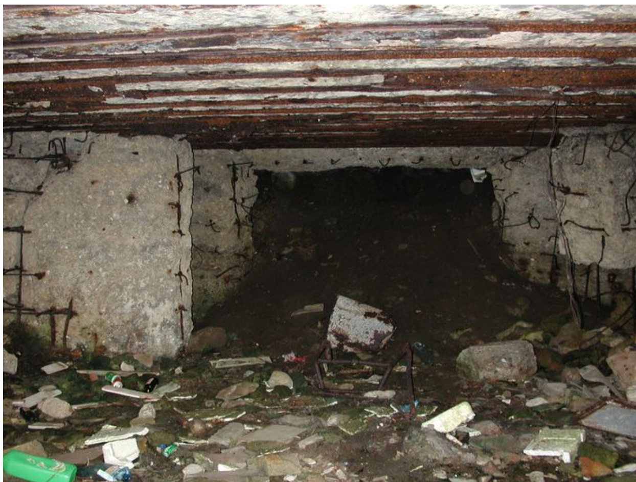
Vue de l'intérieur de la casemate de Beg Tanguy endommagée par le souffle d'une explosion durant le déminage
