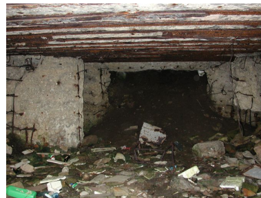
Vue de l'intérieur de la casemate de Beg Tanguy endommagée par le souffle d'une explosion durant le déminage Phot. Guillaume Lécueillier IVR53_20022902015NUCA
