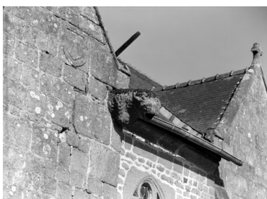
Elévation Sud, chapelle des Fonts : détail d'une gargouille Phot. François Dagorn IVR53_19723500662V
