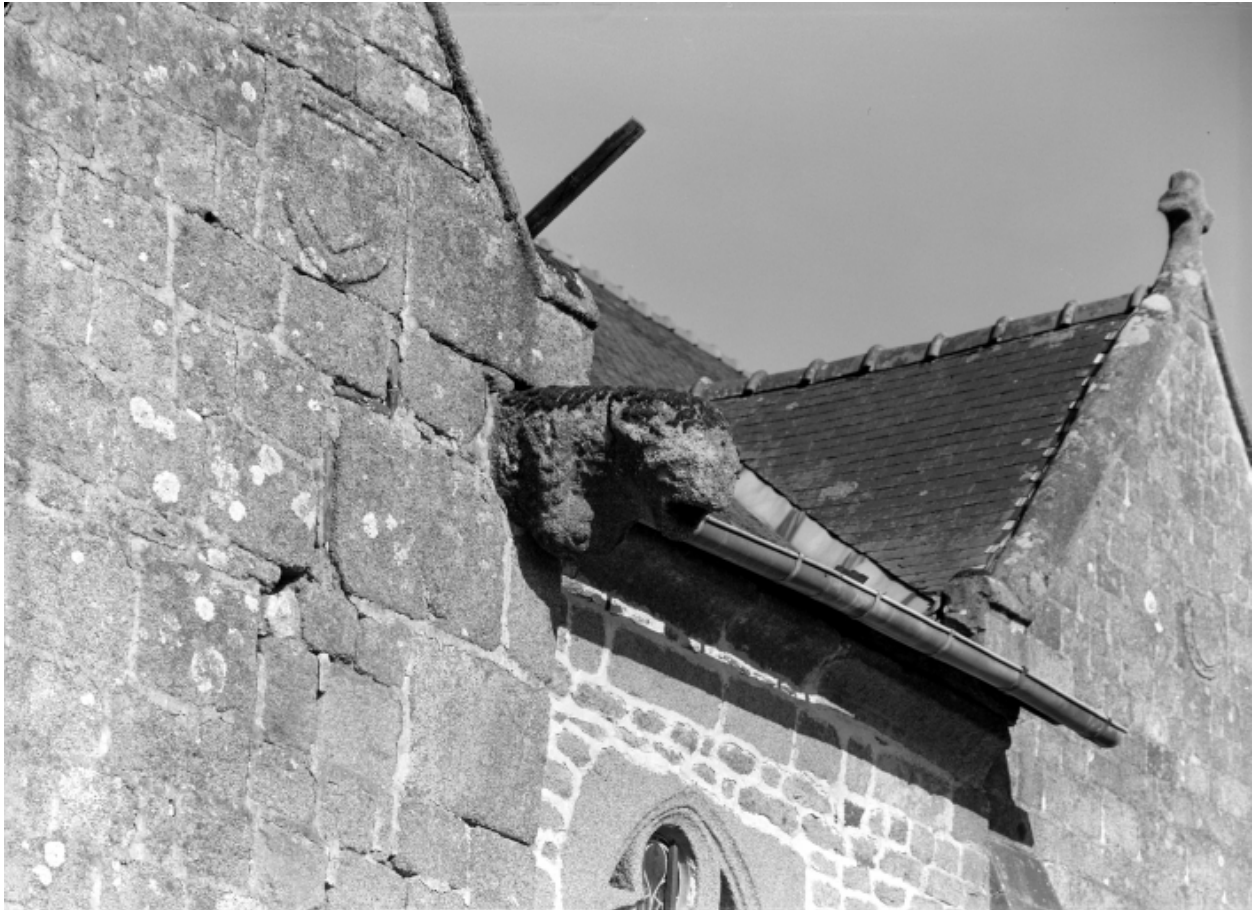
Elévation Sud, chapelle des Fonts : détail d'une gargouille
