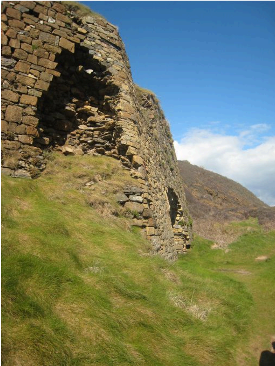
Paroi du four à chaux de la Fraternité avec trou d'obus
