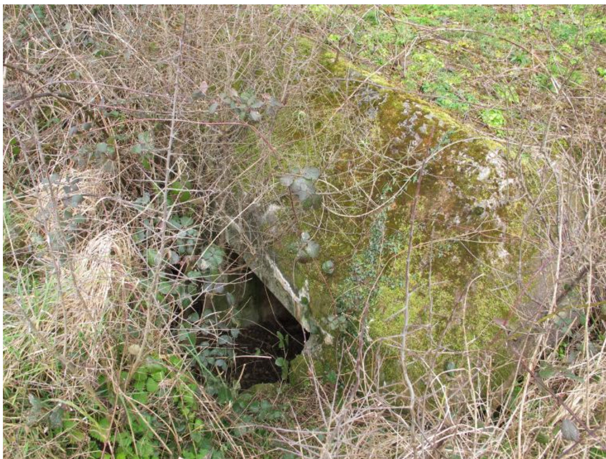
Vue de l'entrée ouest envahie par la végétation (état en 2013)
