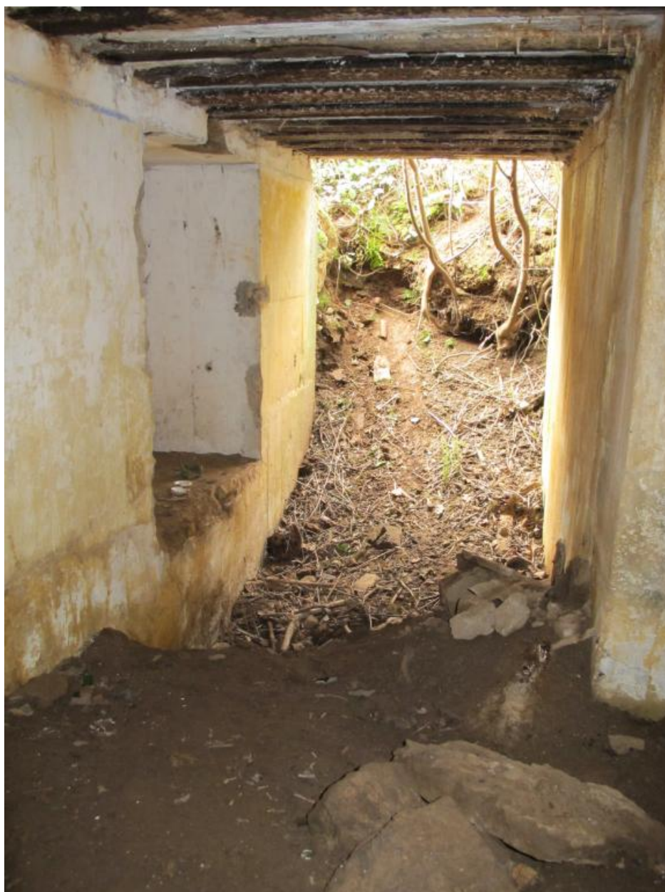
Vue de l'entrée ouest en partie remblayée et envahie par la végétation (état en 2013)
