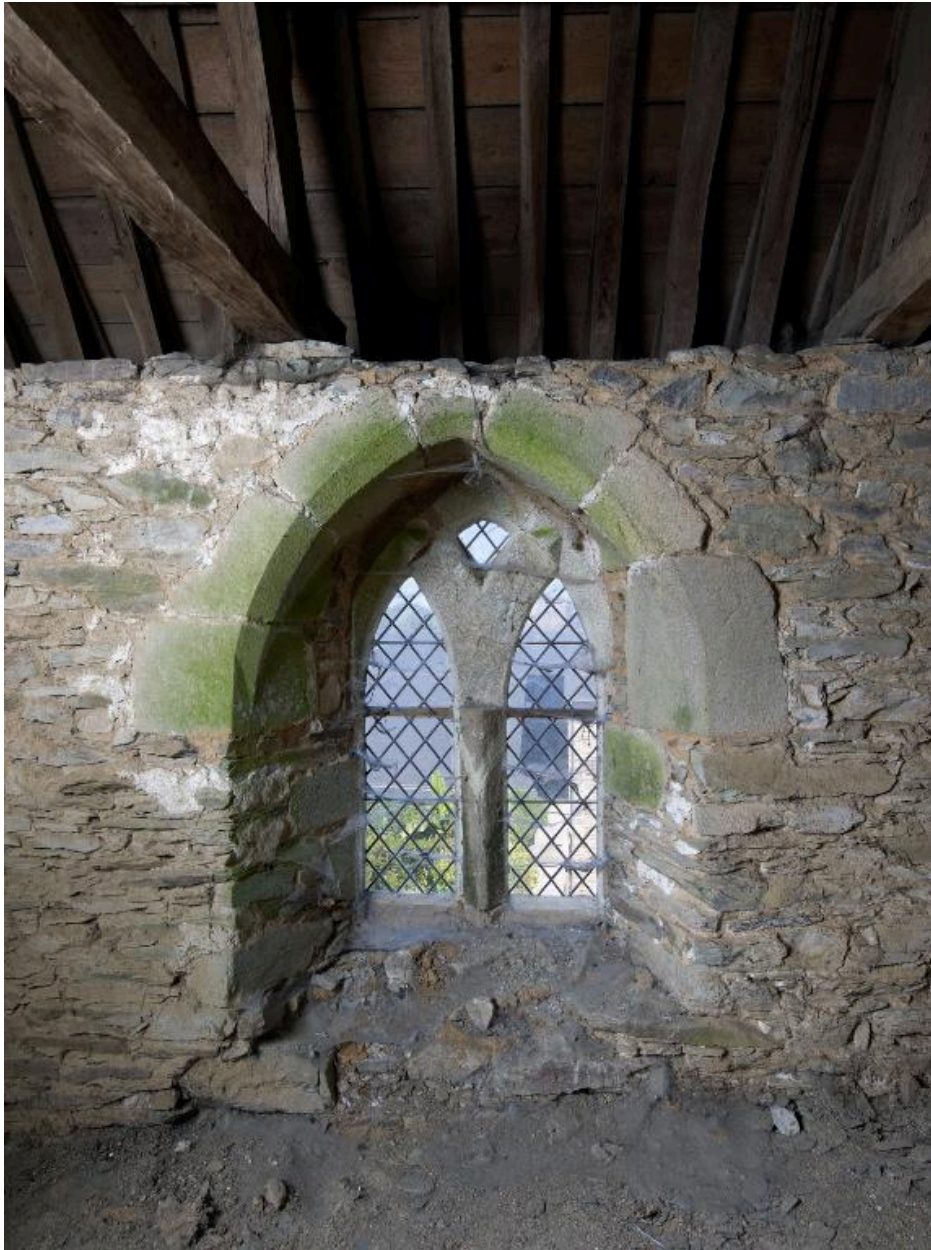
Construction d'angle nord-est. Pièce haute située à l'est. Détail de la fenêtre du chevet
