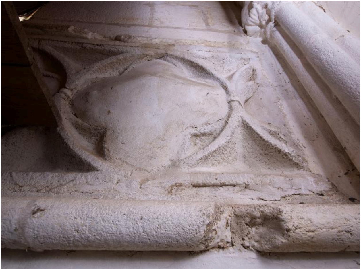
Nef. Ancienne tribune située à l'ouest partiellement dissimulée par le buffet d'orgue. Détail d'un quadrilobe bouché
