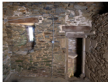
Construction d'angle nord-est. Pièce haute située au nord. Vue intérieure avec desserte de l'escalier en vis et jour Phot. Bernard Bègne IVR53_20142201178NUCA
