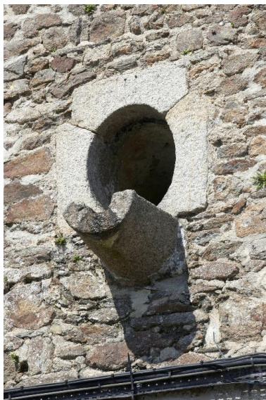
Vue de détail de l'une des gargouilles du casernement du fort du Portzic (dans l'emprise militaire) Phot. Bernard Bègne IVR53_20122901193NUCA
