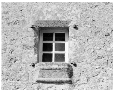
Château, mur sud, détail de la fenêtre. Phot. Guy Artur, Phot. Norbert Lambart IVR53_19873500260X
