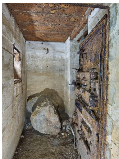
Vue de l'entrée est depuis le sas. A gauche, le créneau blindé protégeant l'entrée est (coffrage en bois en place). A droite, la porte blindée à deux vantaux Phot. Bernard Bègne IVR53_20253501370NUCA
