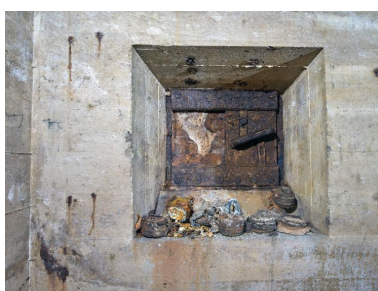
Vue de détail de l'ouverture de tir blindée de l'entrée est. Sur le rebord se trouvent regroupés différents artefacts : un masque à gaz et huit cartouches de masque à gaz Phot. Bernard Bègne IVR53_20253501369NUCA
