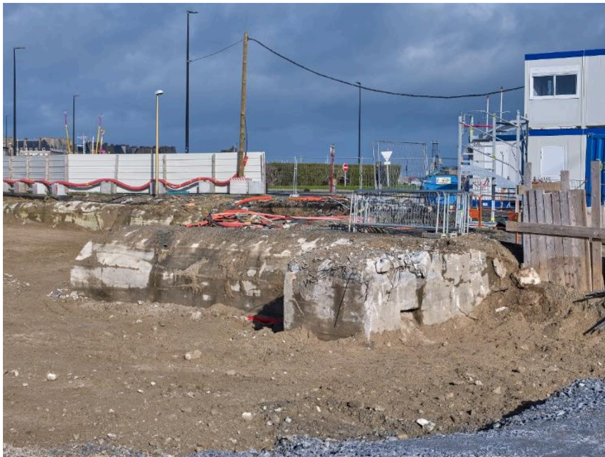
Vue générale depuis le sud (couverture photographique du 22 janvier 2026). La partie en saillie correspond au poste d'observation. Les planches situées à droite servent à étayer l'une des deux entrées du bunker
