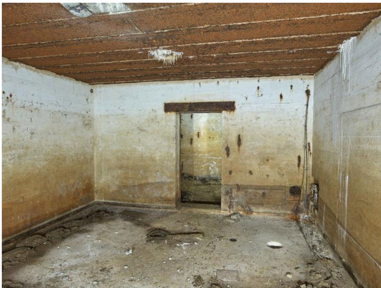
Vue du magasin à munitions ouest. Sur le mur du fond à droite, câblage électrique pour l'alimentation des plafonniers
