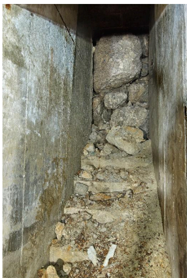
Vue de l'entrée est avec son escalier. Cet accès est totalement remblayé Phot. Bernard Bègne IVR53_20253501371NUCA
