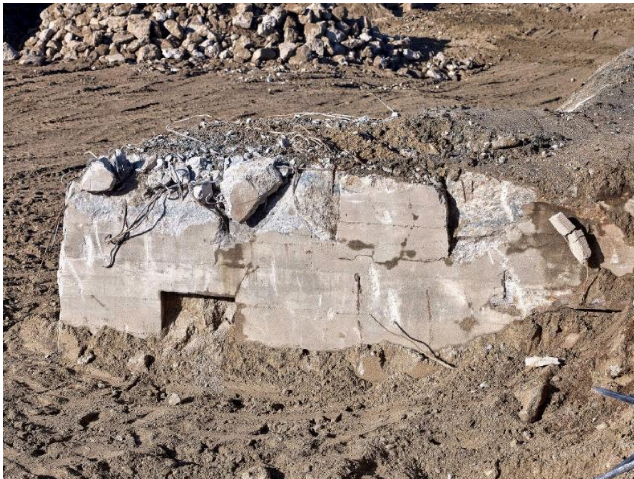
Vue de détail de la partie en saillie : poste d'observation dit Tobruk (couverture photographique du 22 janvier 2026). Au ras-du-sol, l'entrée dédiée du Tobruk. La partie haute est en mauvais état : les fers à béton sont apparents
