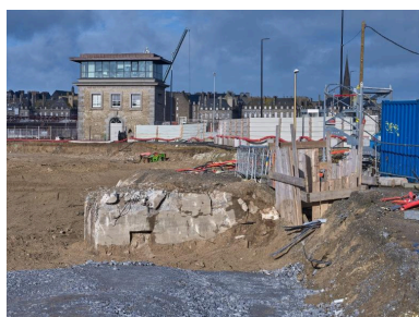
Vue générale depuis le sud-est (couverture photographique du 22 janvier 2026). La partie en saillie à gauche correspond au poste d'observation. Les planches masquent l'une des deux entrées du bunker. En arrière-plan, poste de commande de l'écluse du Naye Phot. Bernard Bègne IVR53_20263500068NUCA
