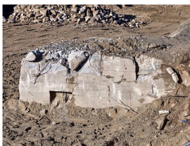
Vue de détail de la partie en saillie : poste d'observation dit Tobruk (couverture photographique du 22 janvier 2026). Au ras-du-sol, l'entrée dédiée du Tobruk. La partie haute est en mauvais état : les fers à béton sont apparents Phot. Bernard Bègne IVR53_20263500069NUCA
