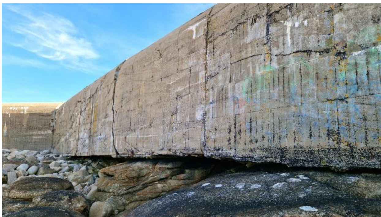
Vue de détail au sud de la grève. Le mur apparaît sapé
