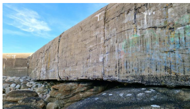
Vue de détail au sud de la grève. Le mur apparaît sapé Phot. Guillaume Lécueillier IVR53_20265610137NUCA
