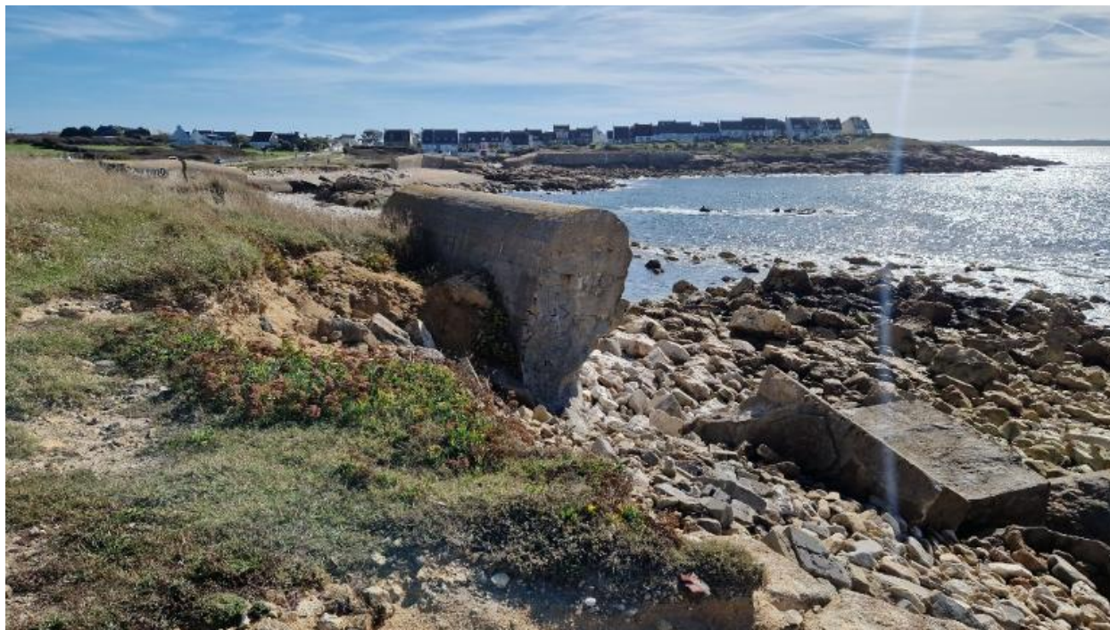
Vue de détail au nord de la grève. Des sections de mur sont couchées sur la grève du côté de la mer
