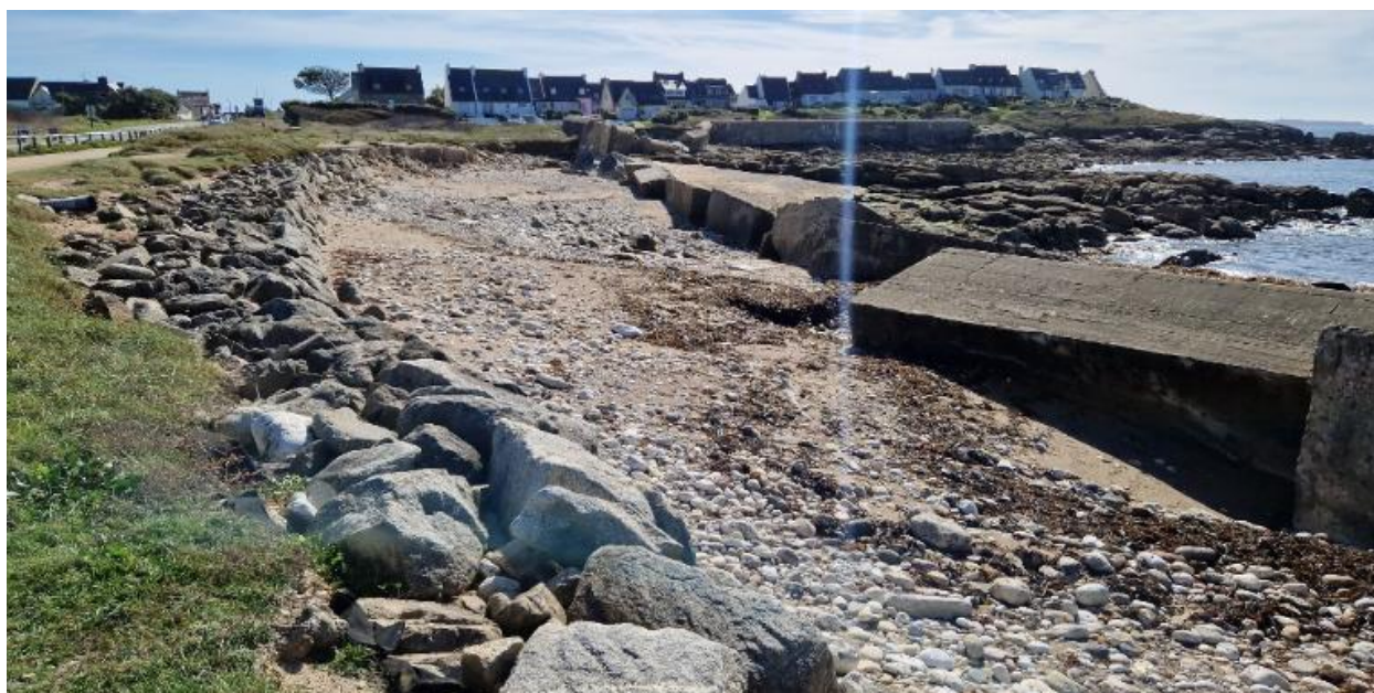
Vue générale vers le sud depuis le milieu de la grève. Des sections de mur sont couchées sur la grève du côté de la mer
