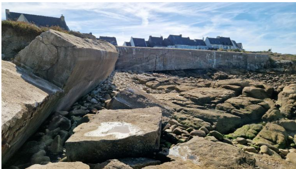
Vue générale au sud de la grève. Des sections de mur sont couchées sur la grève du côté de la mer. En arrière-plan : la pointe du Courégant
