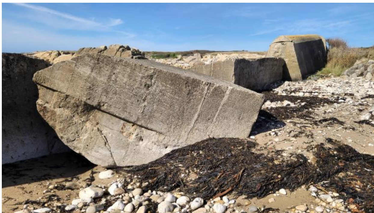
Vue de détail depuis le milieu de la grève. Des sections de mur sont couchées sur la grève du côté de la mer
