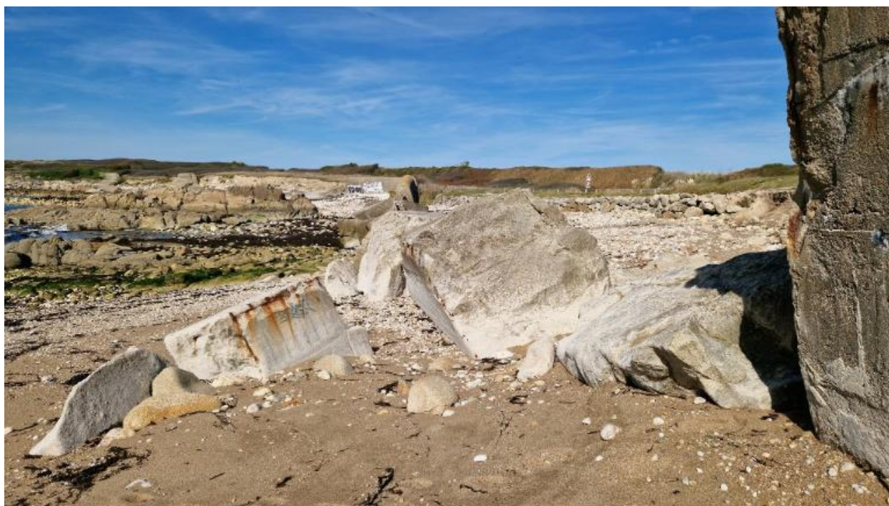
Vue générale vers le nord depuis le milieu de la grève. Des éléments du mur gisent disloqués sur la grève
