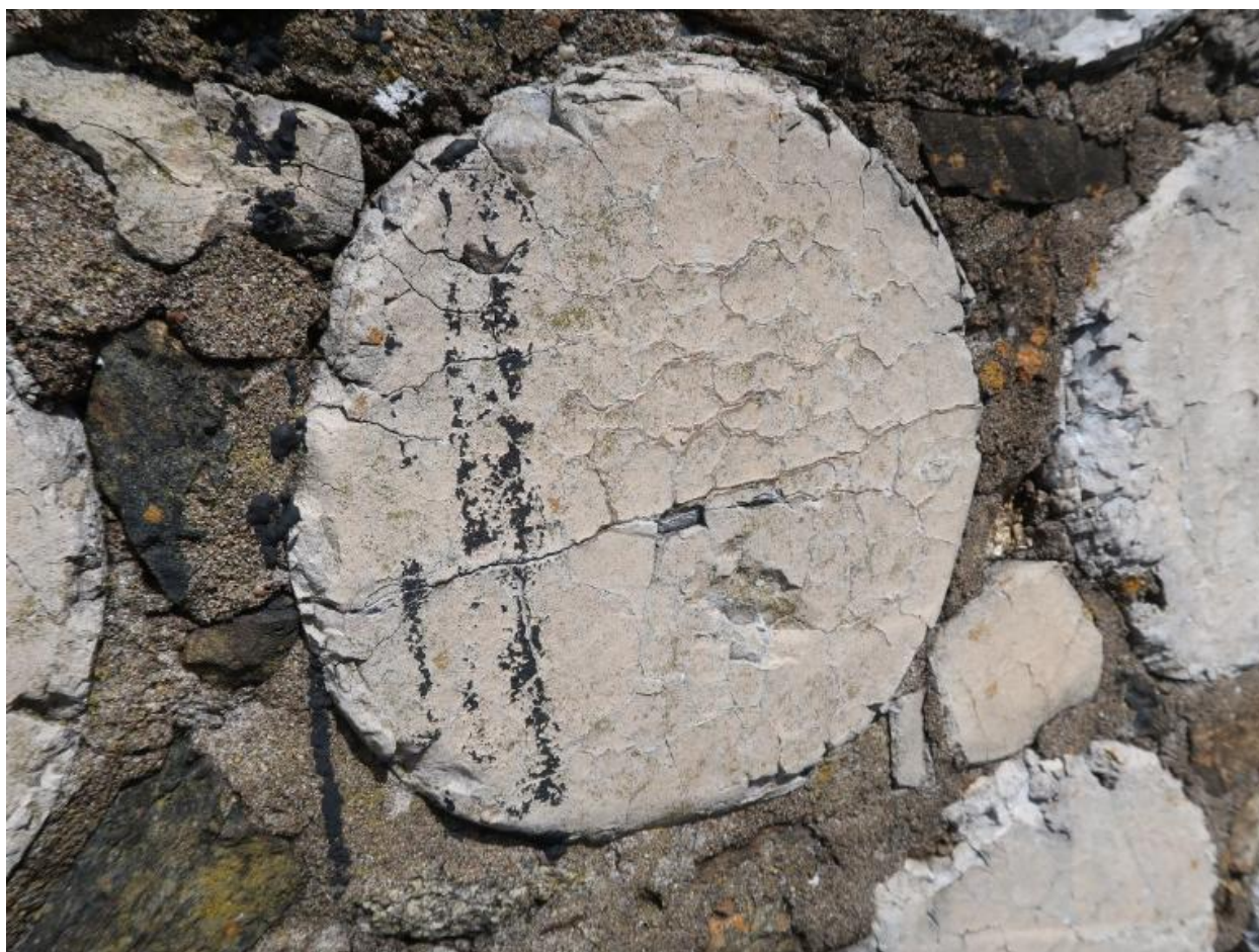
Quai russe : vue rapprochée du ciment sous forme de baril
