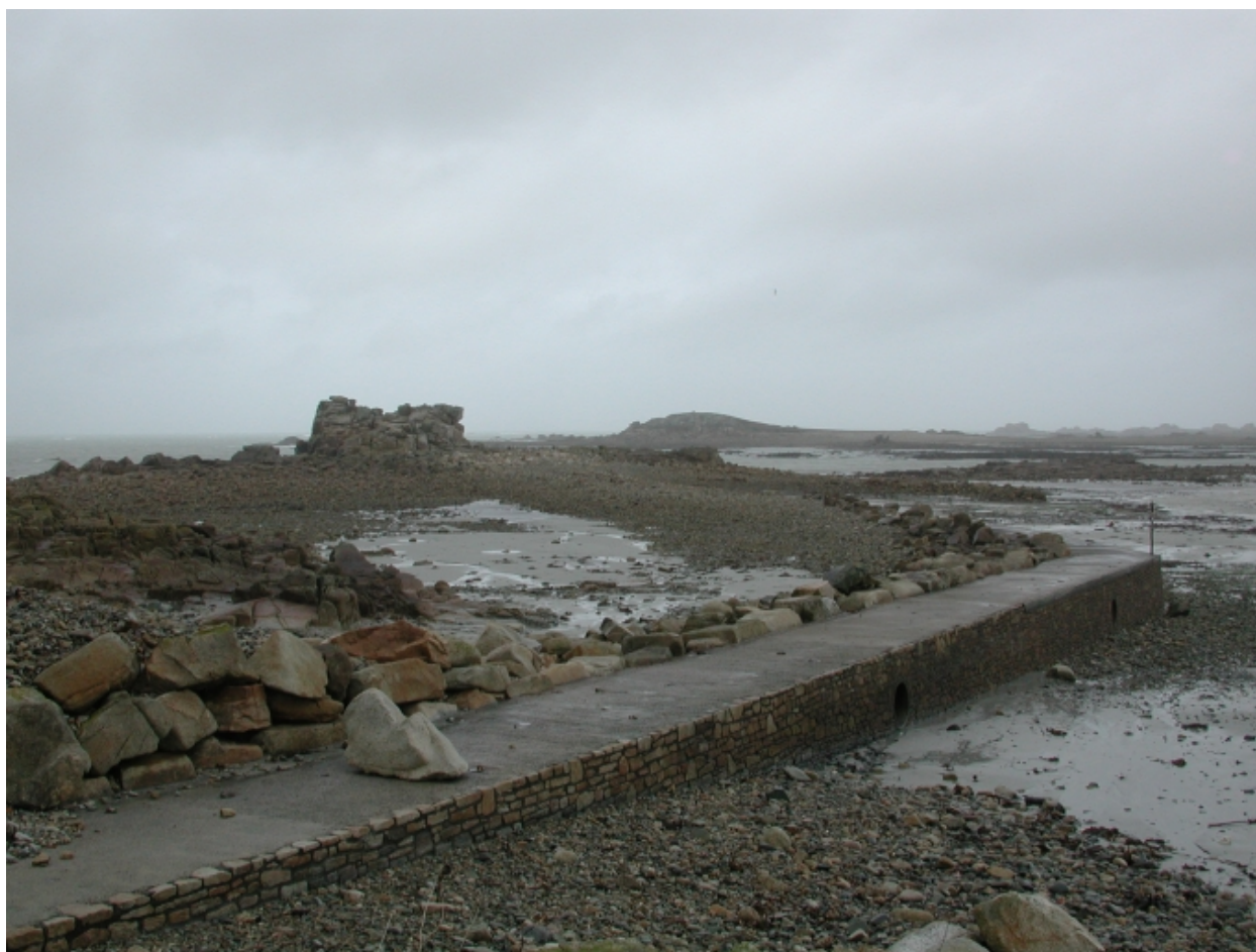
Vue de l'état de la cale de mi-marée après la tempête de mars 2008
