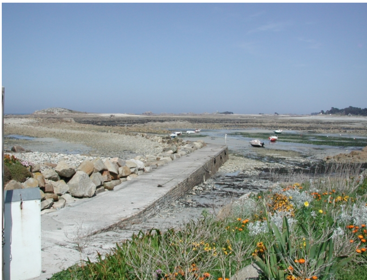
Vue de l'ancrage de la cale : remarquer l'absence de fruit du mur
