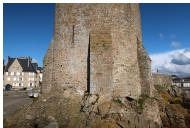
Vue des trois contreforts de la tour ouest. Ils sont élevés en pierre de taille. Du côté sud (à droite), la maçonnerie du pied de la tour est très dégradée Phot. Guillaume Lécueillier IVR53_20263510543NUCA
