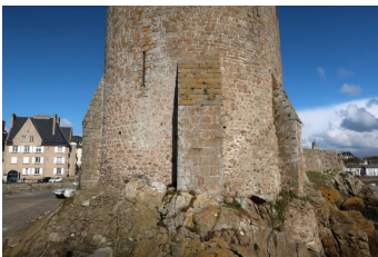
Vue des trois contreforts de la tour ouest. Ils sont élevés en pierre de taille. Du côté sud (à droite), la maçonnerie du pied de la tour est très dégradée
