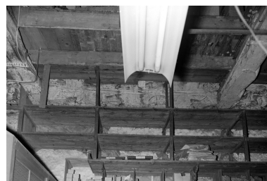
Première travée nord, sablière. Phot. Auteur inconnu IVR53_19693500053V
