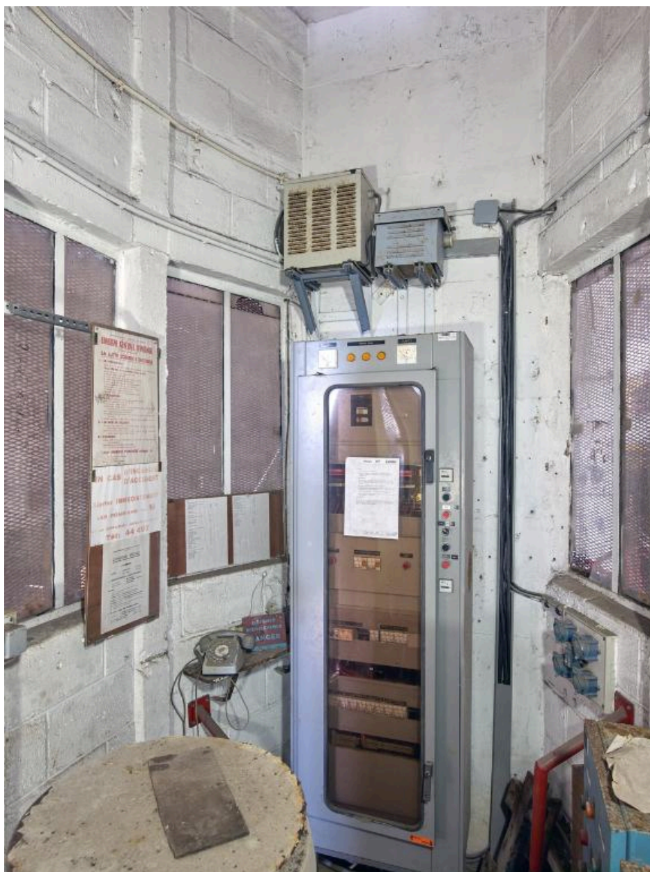
Vue du local des pompes nord situé entre les alvéoles A et B : tableau électrique des pompes 1 et 2, notice de mise en route et d'entretien, consigne générale d'incendie, liste des numéros et poste téléphonique
