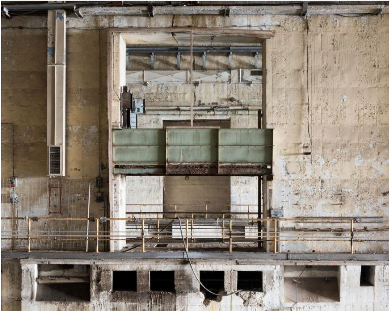
Vue de l'alcôve A (n° 24) : équipements électriques en place dans l'épaisseur du mur de refend situé entre les alcôves A et B
