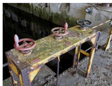
Vue des commandes des vannes du bateau-porte fermant le bassin (vers l'intérieur). On peut lire de gauche à droite : BALLAST n° 5, BALLAST n° 6, REMPLISSAGE
