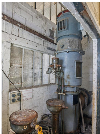
Vue du local des pompes sud situé entre les alvéoles A et B : pompe avec son système de graissage (?). Au premier plan, les commandes de pompe : elles fonctionnaient avec une manivelle. Sur le mur : consigne de sécurité concernant le puisard Phot. Bernard Bègne IVR53_20235600604NUCA
