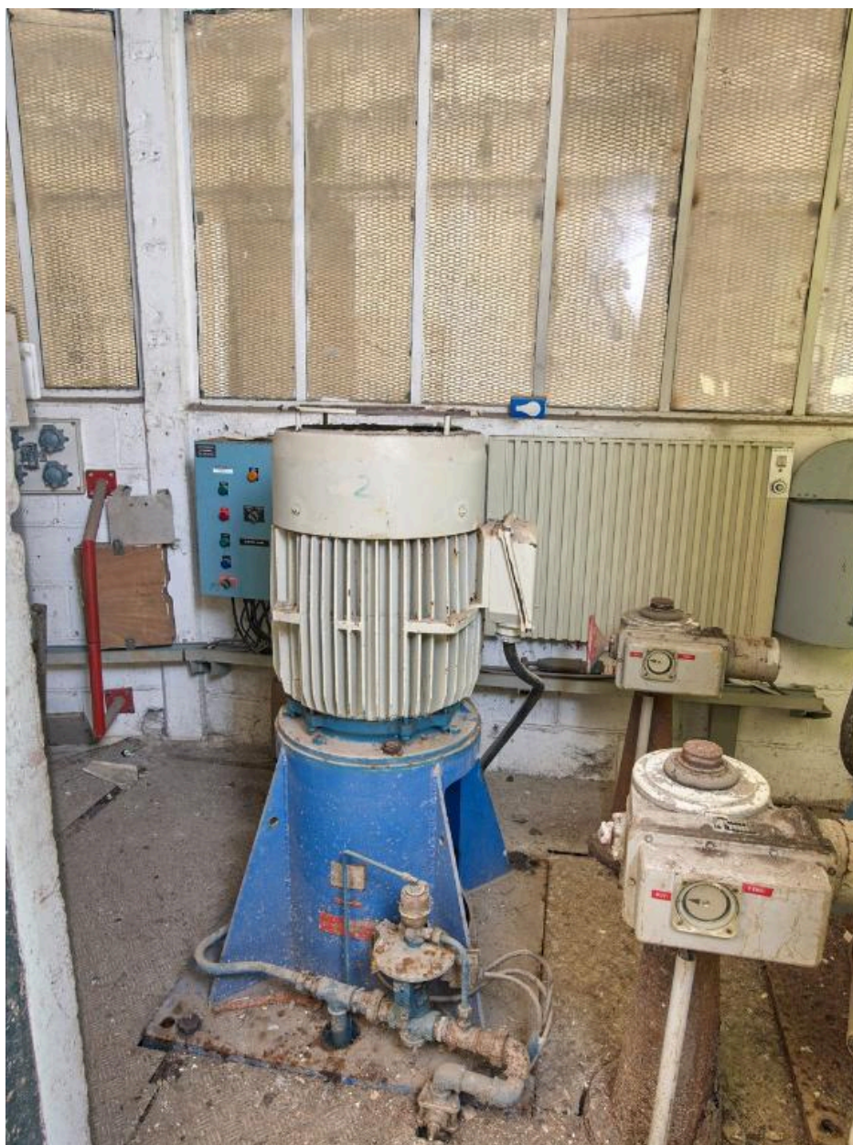
Vue du local des pompes nord situé entre les alvéoles A et B : pompe 2, avec vannes et tableau électrique de commande
