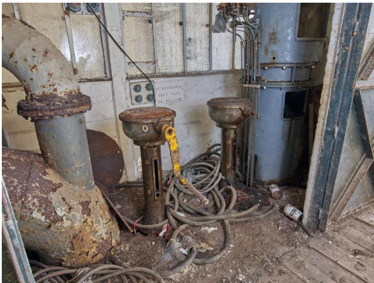
Vue du local des pompes sud situé entre les alvéoles A et B : commandes de pompe (dans cet espace, il faut imaginer la forte odeur de graisse mécanique). Elles fonctionnaient avec une manivelle. Sur le mur : consigne de sécurité concernant le puisard
