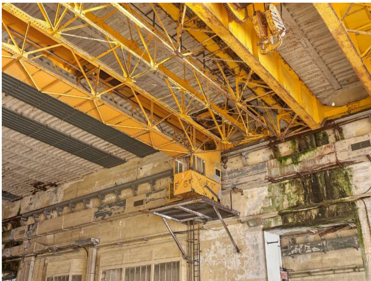
Vue du pont roulant avec son treuil. Il disposait d'une capacité maximum de levage de 5 tonnes
