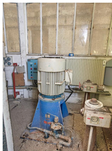
Vue du local des pompes nord situé entre les alvéoles A et B : pompe 2, avec vannes et tableau électrique de commande Phot. Bernard Bègne IVR53_20235600606NUCA
