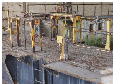
Vue des commandes des vannes de ballast du bateau- porte fermant le bassin Phot. Bernard Bègne IVR53_20235600616NUCA
