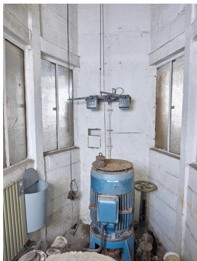
Vue du local des pompes nord situé entre les alvéoles A et B : pompe 1. Sur le mur, double interrupteur à flotteur avec contrepoids Phot. Bernard Bègne IVR53_20235600607NUCA
