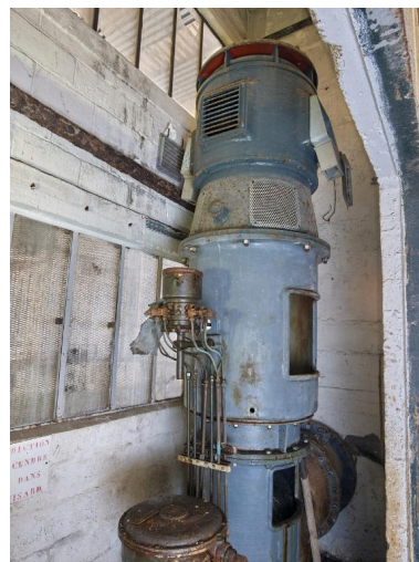
Vue du local des pompes sud situé entre les alvéoles A et B : pompe avec son système de graissage (?). Au premier plan, l'une des deux commandes de pompe : elles fonctionnaient avec une manivelle
