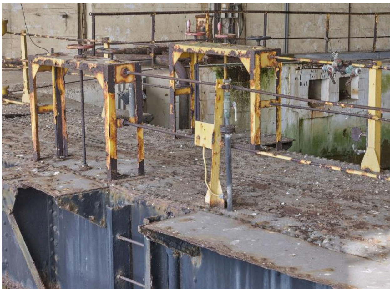
Vue des commandes des vannes de ballast du bateau-porte fermant le bassin
