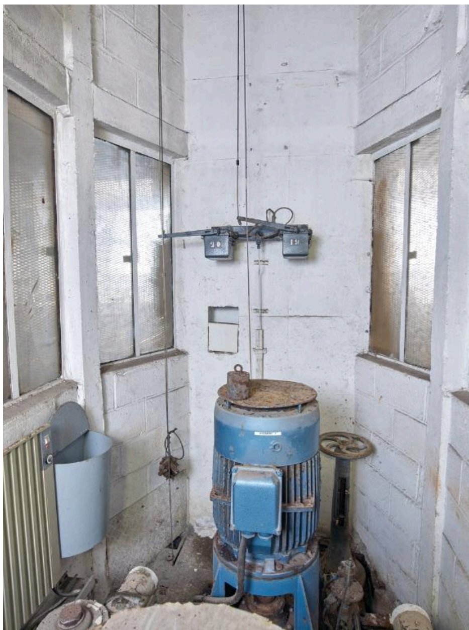
Vue du local des pompes nord situé entre les alvéoles A et B : pompe 1. Sur le mur, double interrupteur à flotteur avec contrepoids
