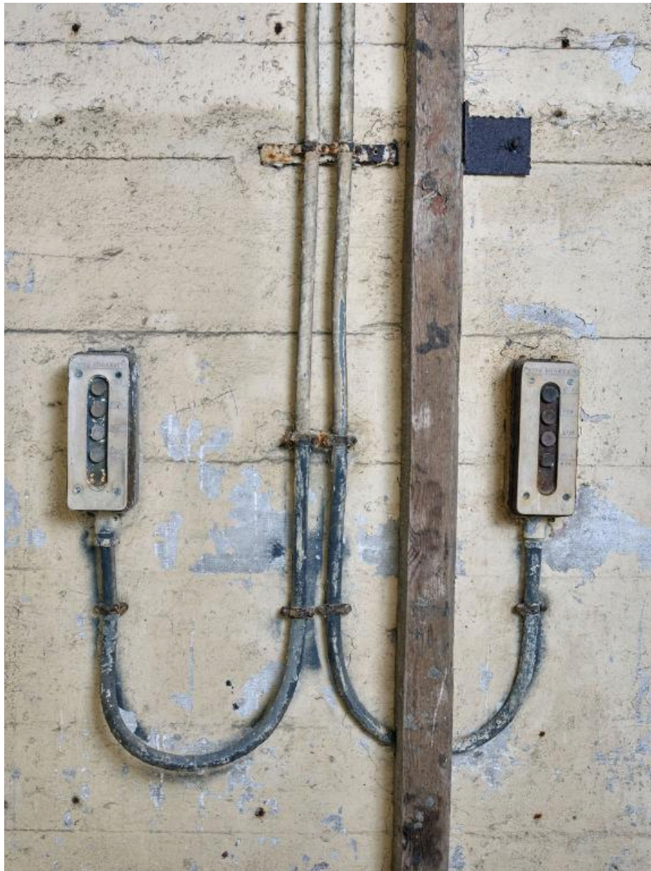
Vue des commandes électriques des portes blindées de protection A et B. On peut lire : Porte blindée (A), Porte blindée (B), O[uvertu]re, F[ermetu]re, A[r]ret, plus bas
