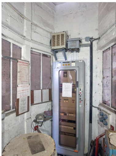
Vue du local des pompes nord situé entre les alvéoles A et B : tableau électrique des pompes 1 et 2, notice de mise en route et d'entretien, consigne générale d'incendie, liste des numéros et poste téléphonique Phot. Bernard Bègne IVR53_20235600608NUCA
