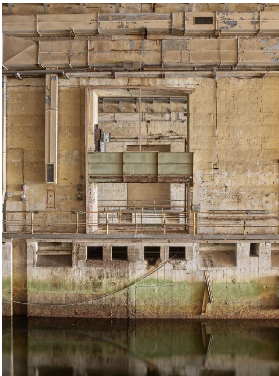
Vue du mur de refend entre les alvéoles A et B. Il est rythmé par de grandes ouvertures abritant des tableaux électriques. Sur le mur : le système de chauffage et ventilation. En dessous du niveau du quai, les passages des fluides
