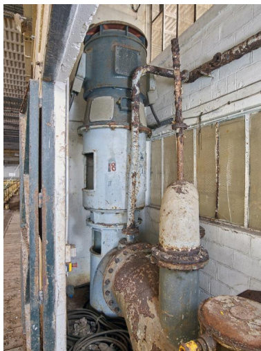
Vue du local des pompes sud situé entre les alvéoles A et B : pompe avec son système de tuyauterie Phot. Bernard Bègne IVR53_20235600605NUCA
