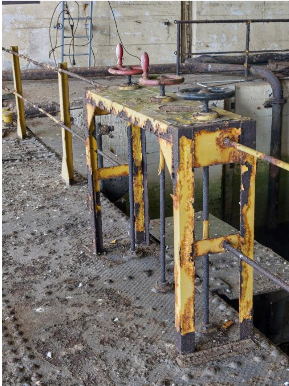
Vue des commandes des vannes du bateau-porte fermant le bassin (vers l'intérieur). On peut lire de gauche à droite : BALLAST n° 5, BALLAST n° 6, REMPLISSAGE
