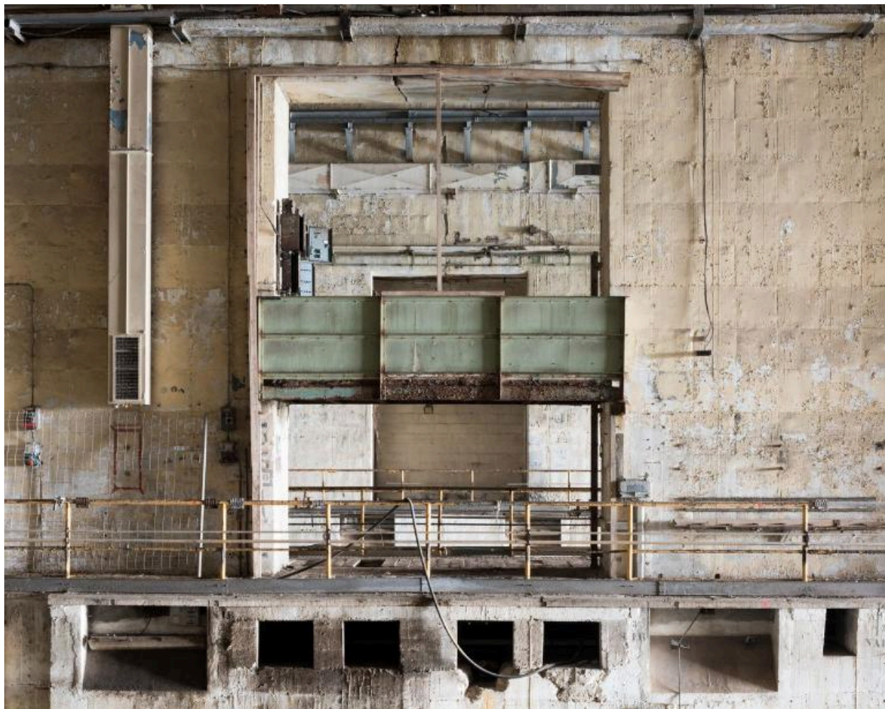
Vue de l'alvéole A (n° 24) : équipements électriques en place dans l'épaisseur du mur de refend situé entre les alvéoles A et B
