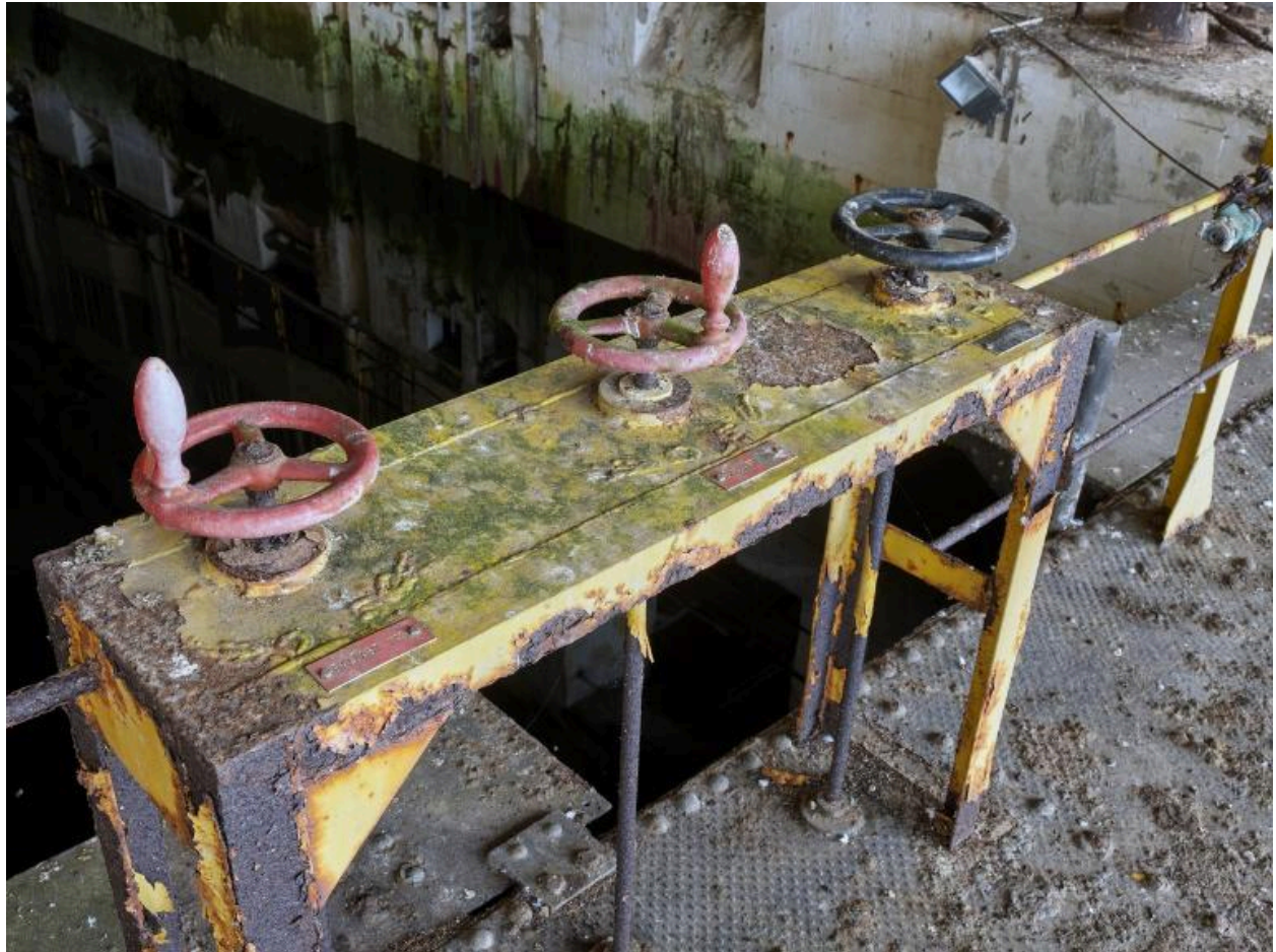
Vue des commandes des vannes du bateau-porte fermant le bassin (vers l'intérieur). On peut lire de gauche à droite : BALLAST n° 5, BALLAST n° 6, REMPLISSAGE
