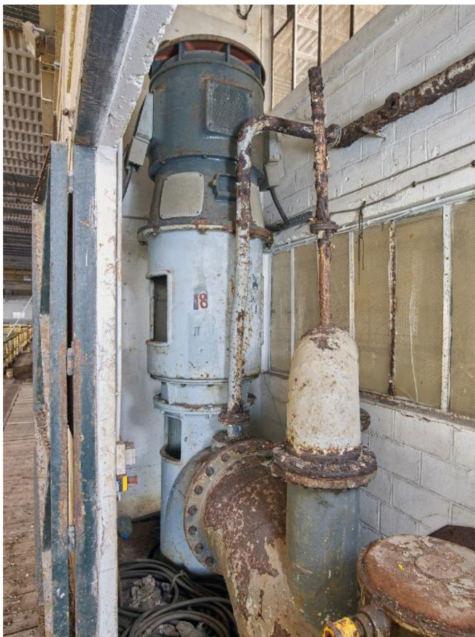
Vue du local des pompes sud situé entre les alvéoles A et B : pompe avec son système de tuyauterie
