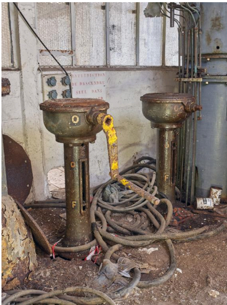
Vue du local des pompes sud situé entre les alvéoles A et B : commandes de pompe (dans cet espace, il faut imaginer la forte odeur de graisse mécanique). Elles fonctionnaient avec une manivelle. Sur le mur : consigne de sécurité concernant le puisard
