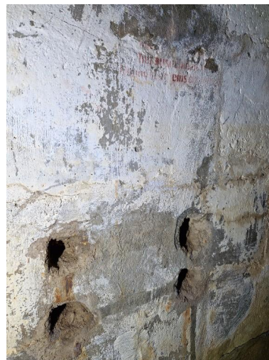
Vue intérieure : salle de garde ouest, emplacement du ventilateur et marquage en allemand Phot. Guillaume Lécueillier IVR53_20242911265NUCA
