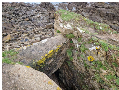
Vue de détail de l'élévation nord. De ce côté, l'érosion marine a emporté le substrat de l'îlot : la maçonnerie de moellon est dans le vide Phot. Guillaume Lécueillier IVR53_20242911242NUCA
