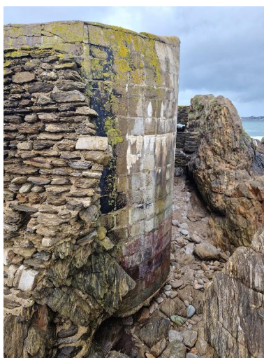
Vue de détail de l'angle nord-est. De ce côté de l'îlot, l'érosion marine a emporté le substrat. Le bunker est construit avec des parpaings dans lesquels a été coulé le béton ; il est recouvert d'une maçonnerie de moellon Phot. Guillaume Lécueillier IVR53_20242911237NUCA
