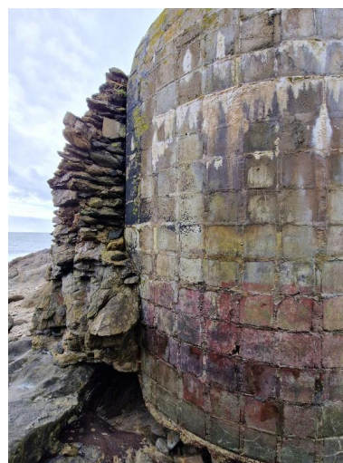
Vue de détail de l'angle nord-est. De ce côté de l'îlot, l'érosion marine a emporté le substrat. Le bunker est construit avec des parpaings dans lesquels a été coulé le béton ; il est recouvert d'une maçonnerie de moellon Phot. Guillaume Lécueillier IVR53_20242911238NUCA
