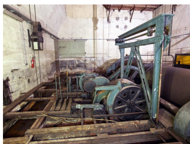
Vue des commandes du treuil et des deux moteurs électriques avec leur frein à tambour. A droite, les deux grands tambours pour les câbles de hissage du charriot du slipway Phot. Bernard Bègne IVR53_20235600021NUCA
