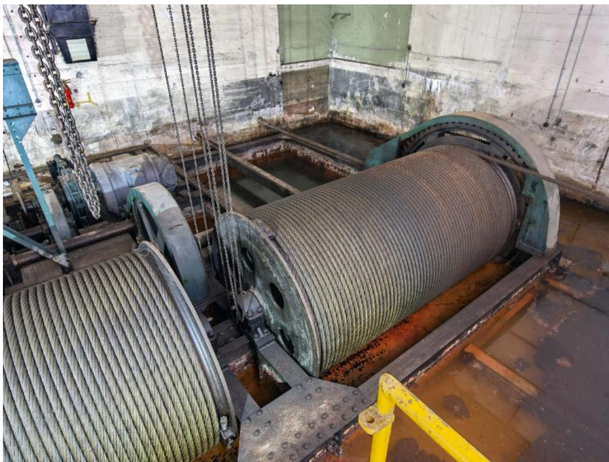
Vue des deux tambours du treuil sur lesquels sont enroulés les câbles. Les tambours mesurent 2 m de diamètre
