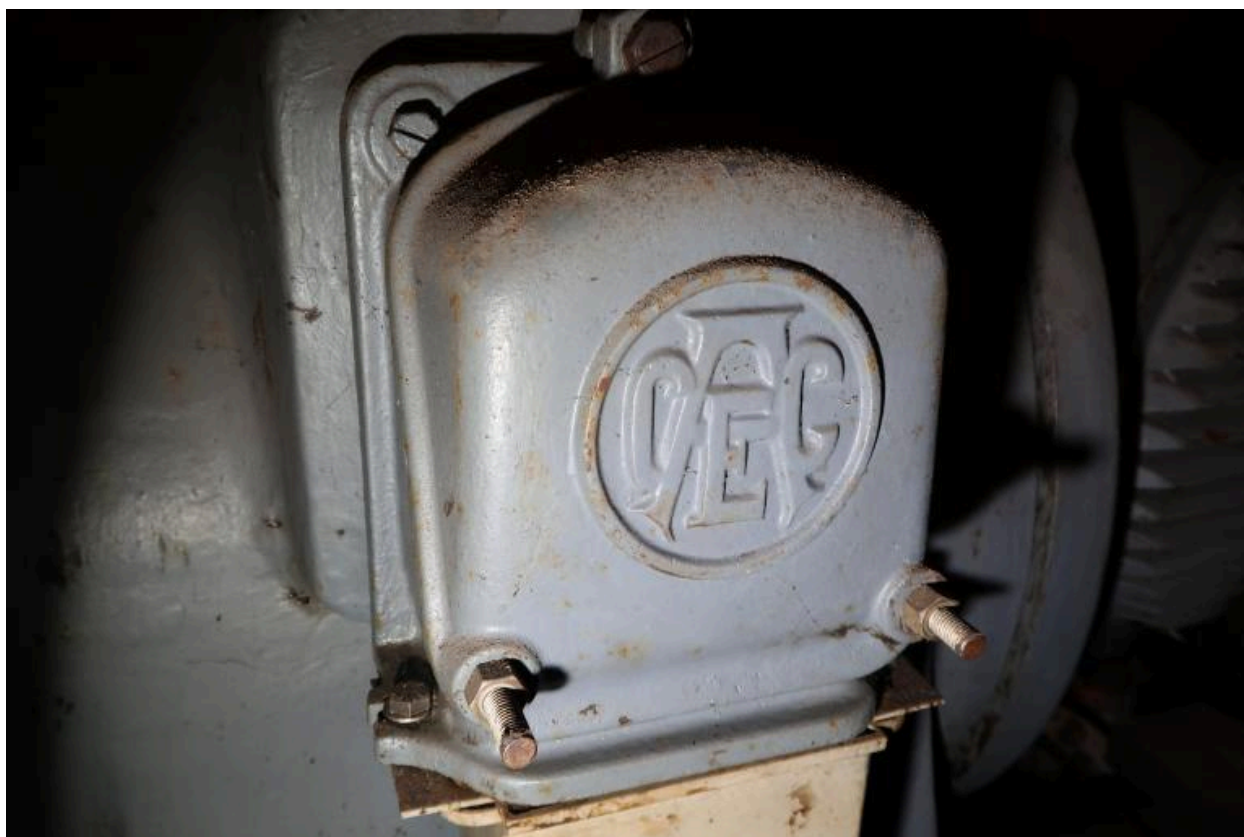
Vue du logo ACEC des Ateliers de constructions électriques de Charleroi situé sur le moteur électrique
