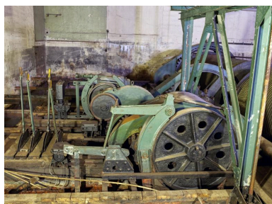
Vue des commandes du treuil et des deux moteurs électriques avec leur frein à tambour. Le bloc frein porte la marque allemande "M.A.N." (Maschinenfabrik Augsburg-Nürnberg) Phot. Bernard Bègne IVR53_20235600022NUCA
