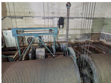
Vue des deux tambours du treuil sur lesquels sont enroulés les câbles. Les tambours mesurent 2 m de diamètre. En arrière-plan, le portique avec le système à vis permettant de suivre le déroulement et l'enroulement des câbles du treuil Phot. Bernard Bègne IVR53_20235600198NUCA
