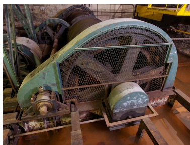
Vue des engrenages sous carter de protection des grands tambours pour les câbles de hissage du charriot du slipway. La salle est inondée (état en janvier 2023) Phot. Bernard Bègne IVR53_20235600020NUCA
