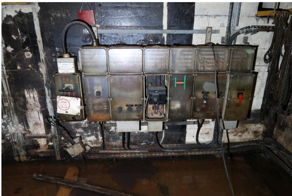
Vue des armoires électriques (n° 1). On peut lire : Sectionneur G[énéral] d'alimentation des chariots transbordeurs du slip, Pompe local treuil... et signalétique DÉFENSE D'ENCLANCHER
