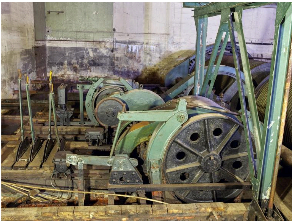
Vue des commandes du treuil et des deux moteurs électriques avec leur frein à tambour. Le bloc frein porte la marque allemande "M.A.N" (Maschinenfabrik Augsburg-Nürnberg)
