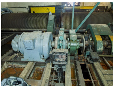
Vue du moteur électrique et du système d'accouplement. Au centre, une résistance (rhéostat ?). Sur le moteur, on reconnaît le logo ACEC des Ateliers de constructions électriques de Charleroi Phot. Bernard Bègne IVR53_20235600191NUCA
