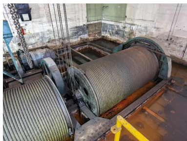
Vue des deux tambours du treuil sur lesquels sont enroulés les câbles. Les tambours mesurent 2 m de diamètre Phot. Bernard Bègne IVR53_20235600199NUCA
