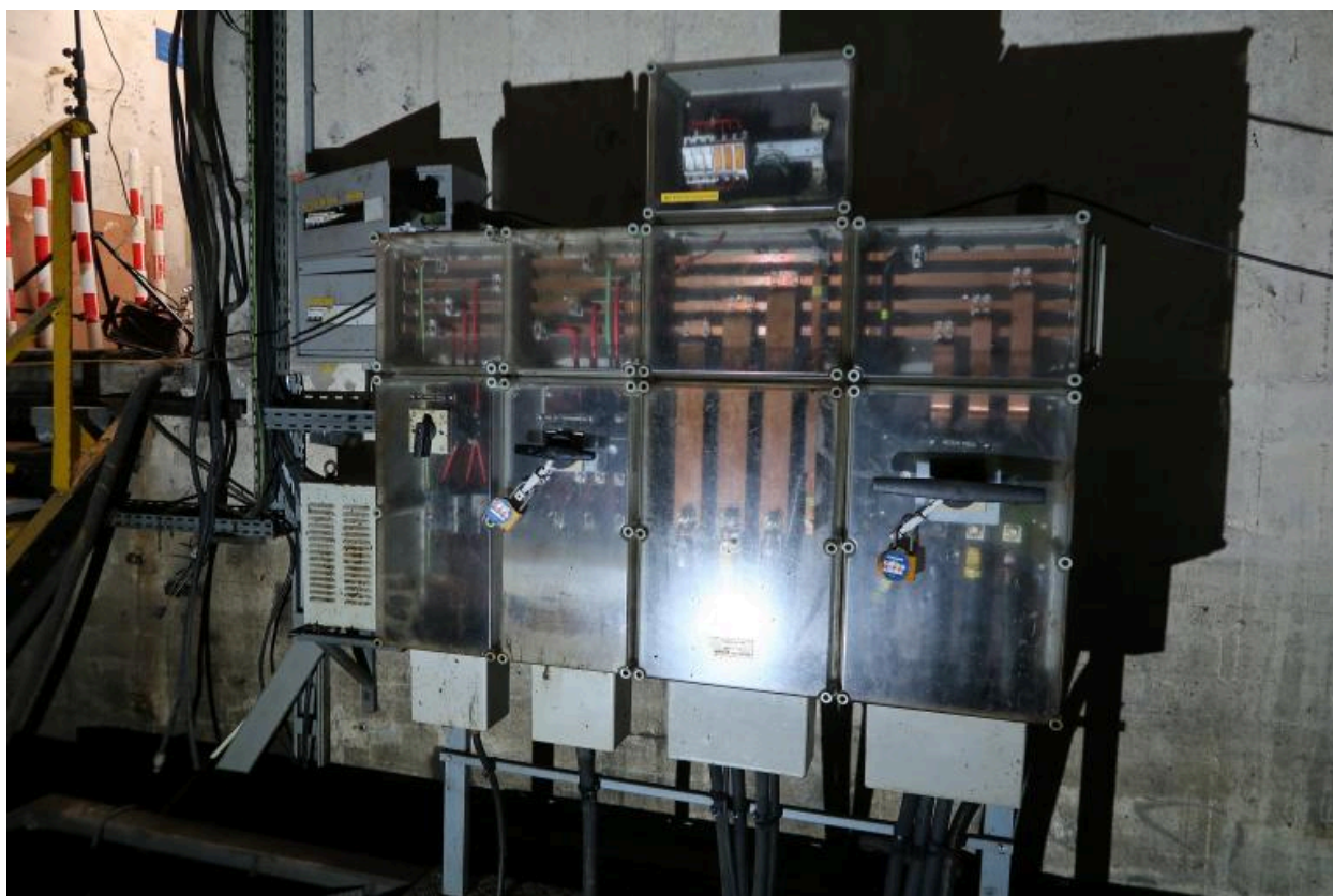
Vue des armoires électriques (n° 2). On peut lire : ECLAIRAGE TREUIL, TABLEAU TRANSBORDEUR, Alimentation générale provenant de la centrale, MOTEUR TREUIL...
