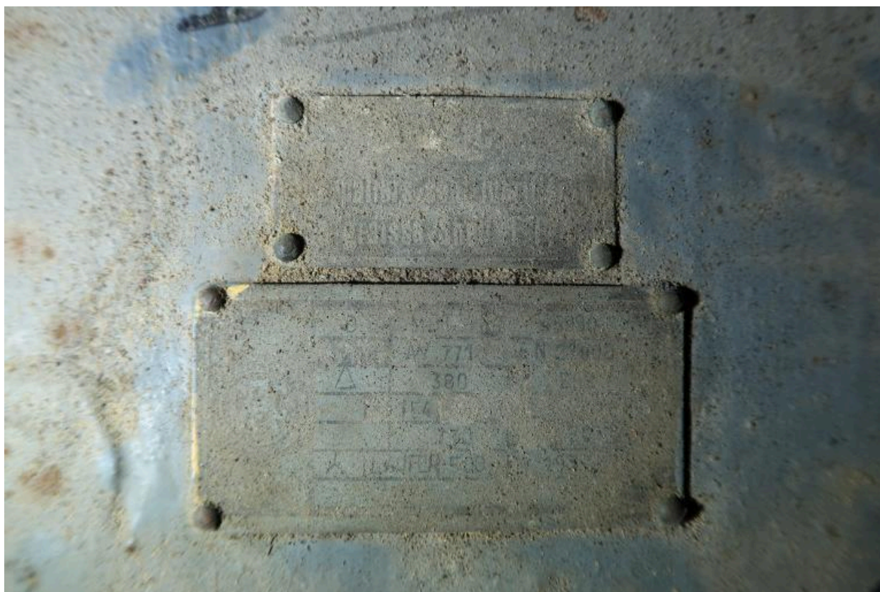
Vue de la plaque constructeur situé sur le moteur électrique (elle est malheureusement quasiment illisible)
