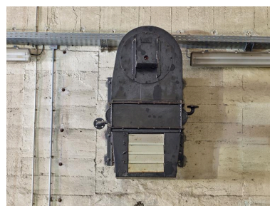
Vue d'élément du système de chauffage et de ventilation (aérotherme : emplacement pour un ventilateur en haut, un échangeur au milieu et une bouche de soufflage à lame en bas). La plaque constructeur - visible en haut - a été peinte Phot. Bernard Bègne IVR53_20235600062NUCA
