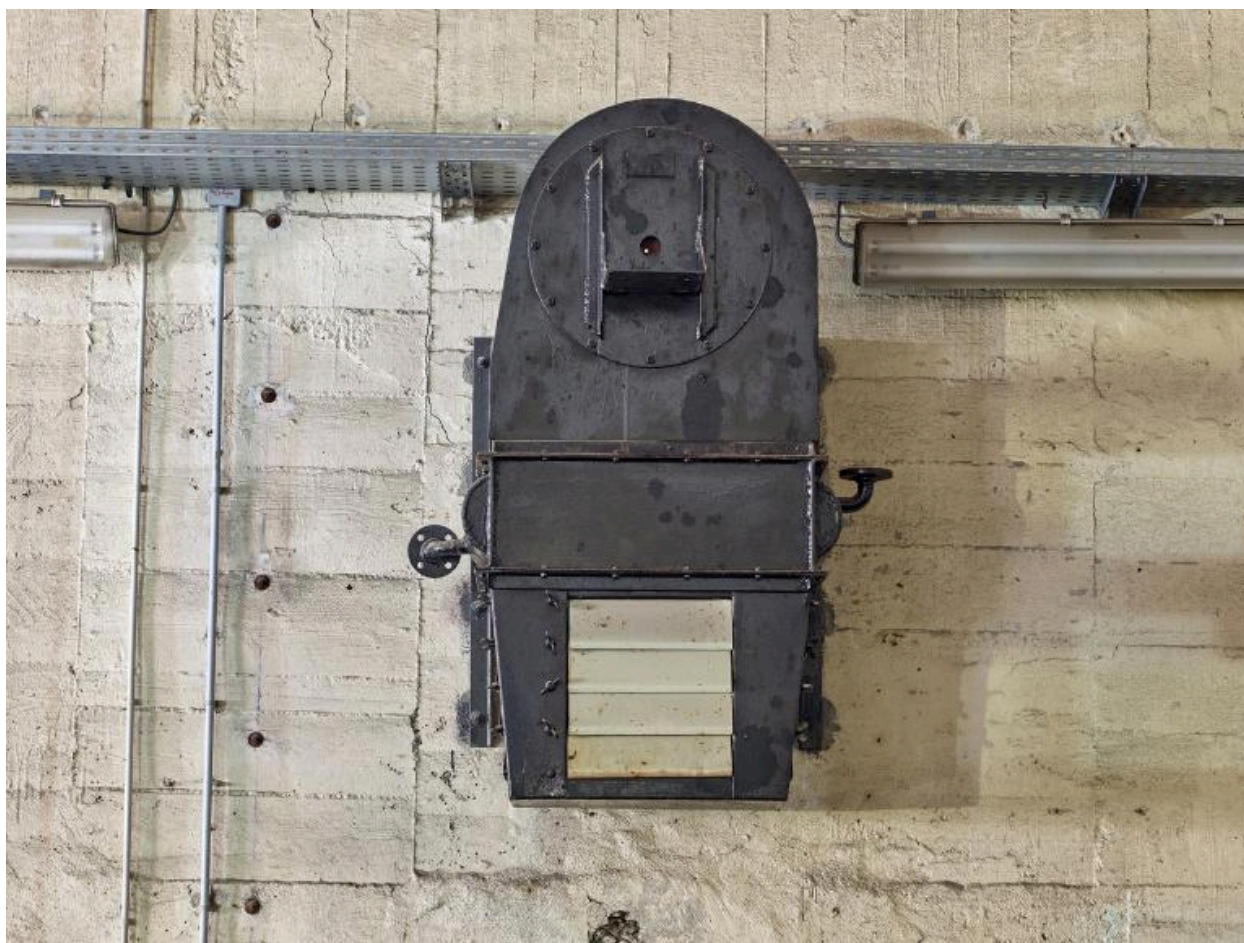
Vue d'élément du système de chauffage et de ventilation (aérotherme : emplacement pour un ventilateur en haut, un échangeur au milieu et une bouche de soufflage à lame en bas). La plaque constructeur - visible en haut - a été peinte
