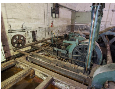
Vue des commandes du treuil et des deux moteurs électriques avec leur frein à tambour Phot. Bernard Bègne IVR53_20235600023NUCA
