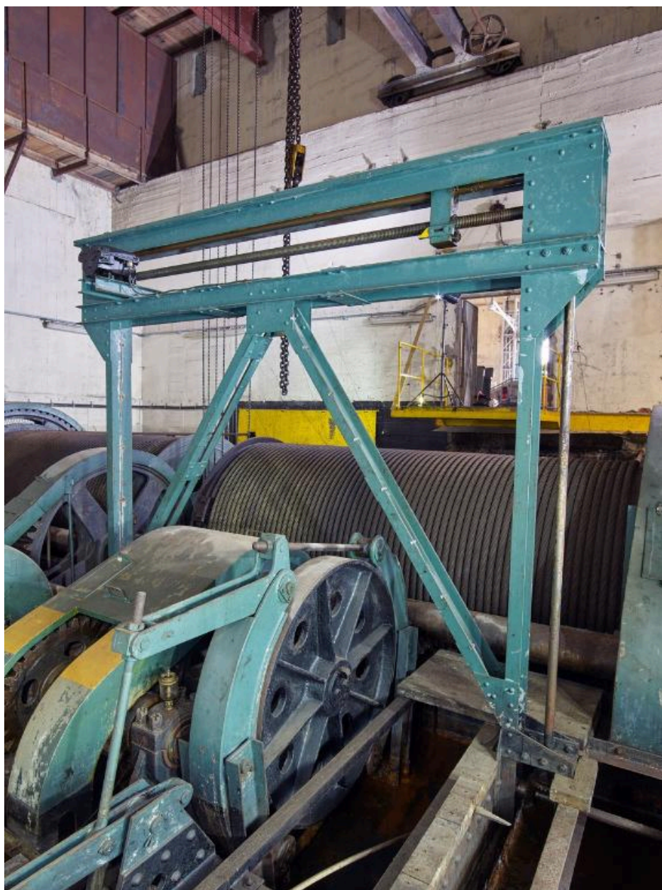
Vue du système à vis permettant de suivre le déroulement et l'enroulement des câbles du treuil
