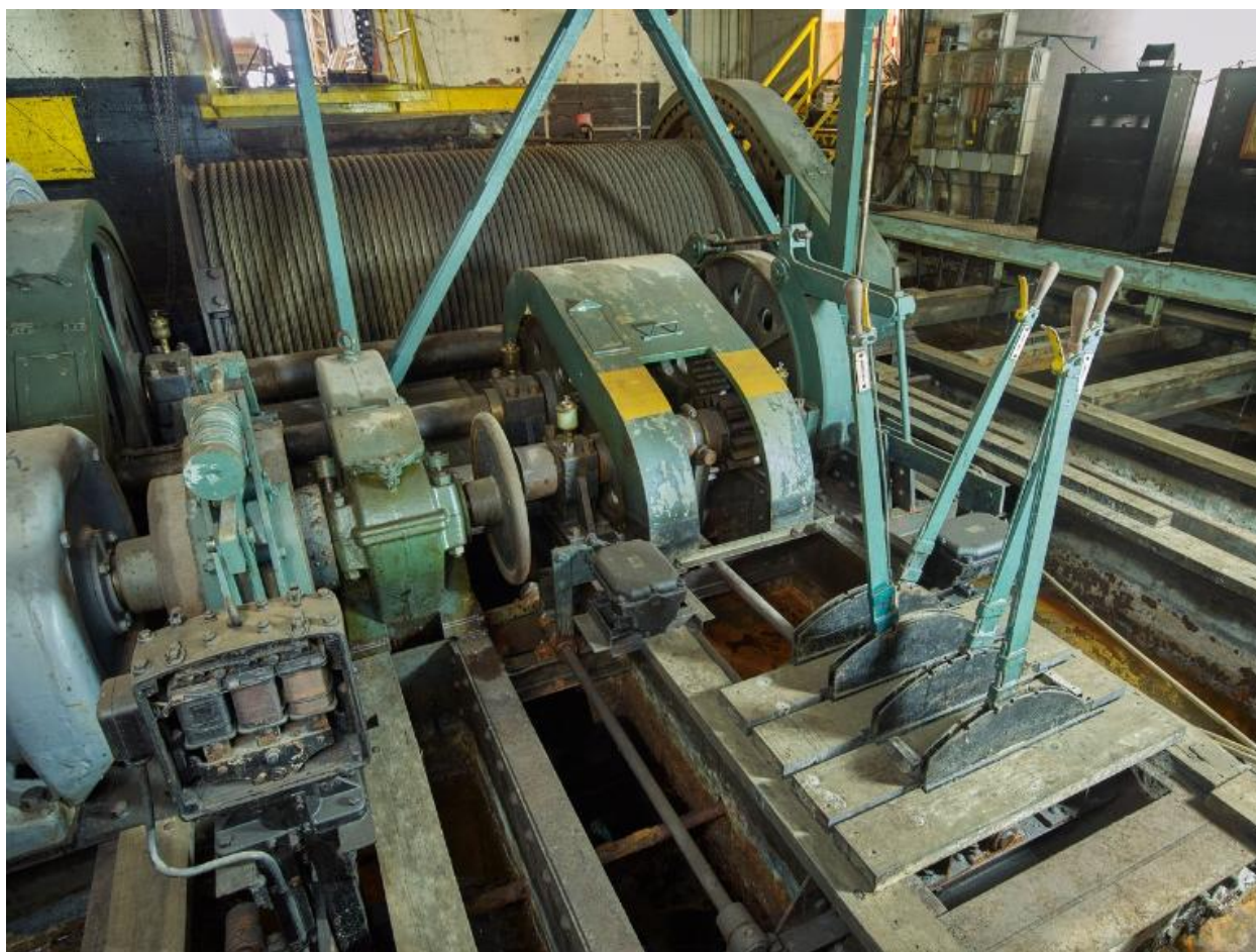
Vue d'une résistance (rhéostat ?) (à gauche) et des commandes mécaniques du treuil par levier (à droite)
