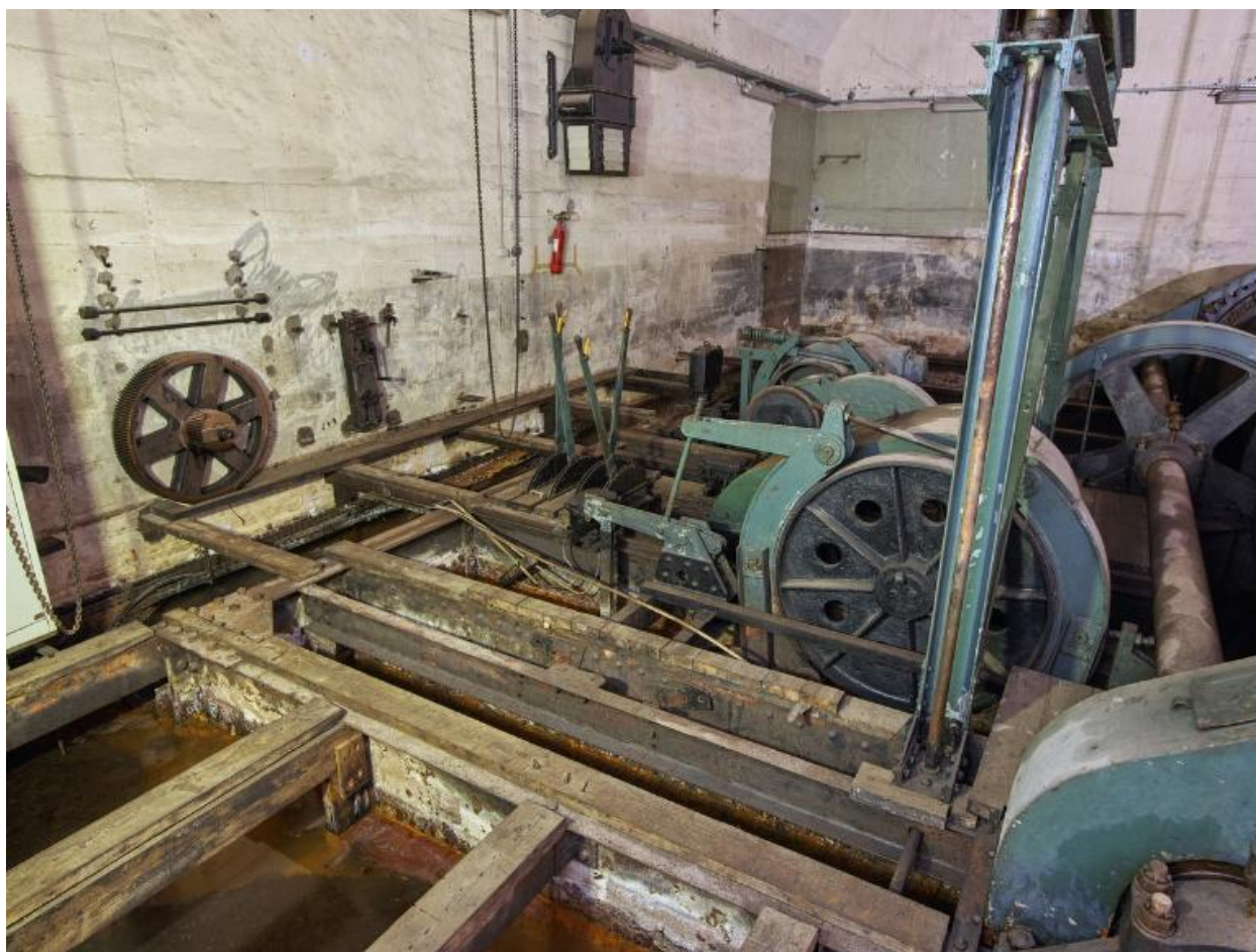
Vue des commandes du treuil et des deux moteurs électriques avec leur frein à tambour
