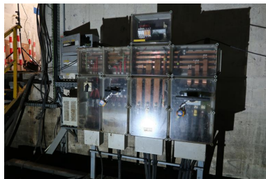
Vue des armoires électriques (n° 2). On peut lire : ECLAIRAGE TREUIL, TABLEAU TRANSBORDEUR, Alimentation générale provenant de la centrale, MOTEUR TREUIL... Phot. Guillaume Lécueillier IVR53_20235605351NUCA
