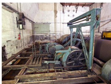
Vue des commandes du treuil et des deux moteurs électriques avec leur frein à tambour. A droite, les deux grands tambours pour les câbles de hissage du charriot du slipway Phot. Bernard Bègne IVR53_2023560021NUCA
