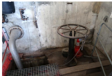
Vue de la vanne située dans l'atelier de la chaudronnerie, magasin puis atelier du Port de La Base de Lorient Phot. Guillaume Lécueillier IVR53_20235605352NUCA
