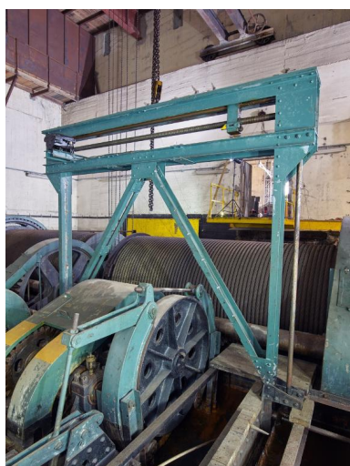
Vue du système à vis permettant de suivre le déroulement et l'enroulement des câbles du treuil Phot. Bernard Bègne IVR53_20235600194NUCA
