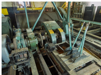
Vue d'une résistance (rhéostat ?) (à gauche) et des commandes mécaniques du treuil par levier (à droite) Phot. Bernard Bègne IVR53_20235600190NUCA
