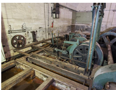
Vue des commandes du treuil et des deux moteurs électriques avec leur frein à tambour Phot. Bernard Bègne IVR53_2023560023NUCA
