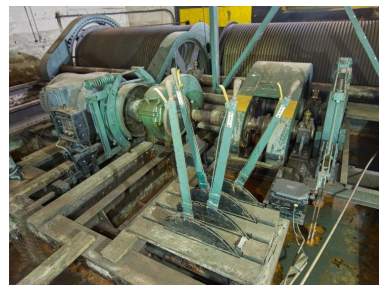
Vue des leviers des commandes mécaniques du treuil. Sur les plaques des leviers, on peut lire : Frein tambour, Embrayage, Frein moteur ; au sol, Petite vitesse (non visible : Grande vitesse) Phot. Bernard Bègne IVR53_20235600192NUCA
