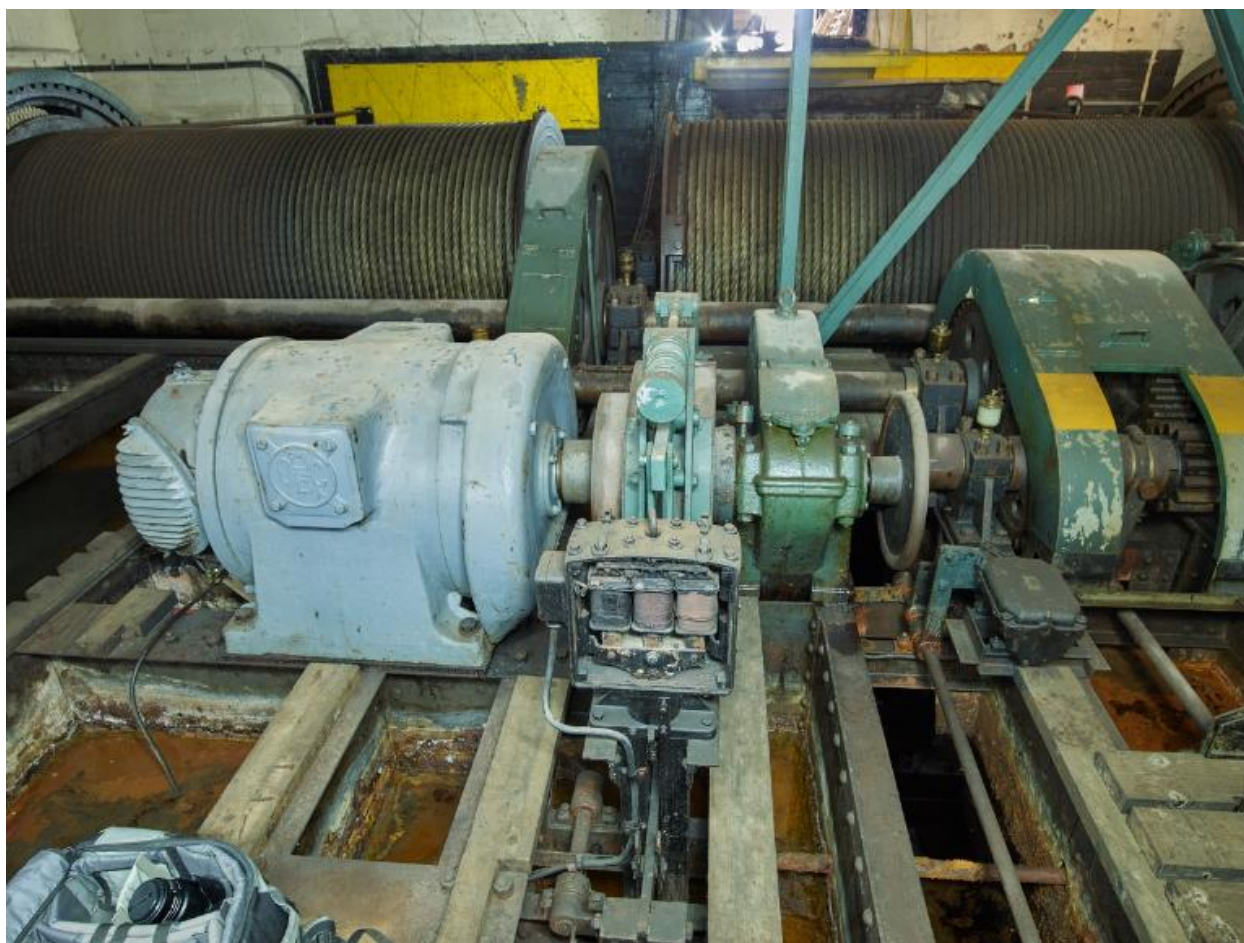
Vue du moteur électrique et du système d'accouplement. Au centre, une résistance (rhéostat ?). Sur le moteur, on reconnaît le logo ACEC des Ateliers de constructions électriques de Charleroi
