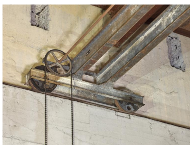
Vue de détail de l'un des deux ponts roulants bipoutres. La chaîne continue permet le déplacement longitudinal du pont roulant (le système est identique à l'opposé mais il a perdu sa chaîne) Phot. Bernard Bègne IVR53_20235600063NUCA
