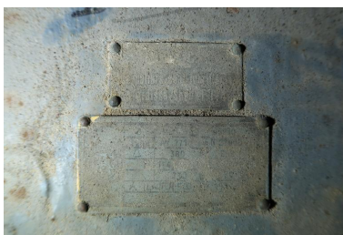
Vue de la plaque constructeur situé sur le moteur électrique (elle est malheureusement quasiment illisible) Phot. Guillaume Lécueillier IVR53_20235605348NUCA
