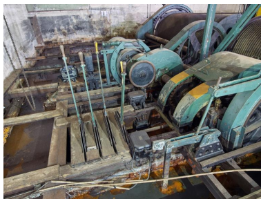
Vue des leviers des commandes mécaniques du treuil. Au sol, on peut lire : Petite vitesse, Grande vitesse Phot. Bernard Bègne IVR53_20235600193NUCA
