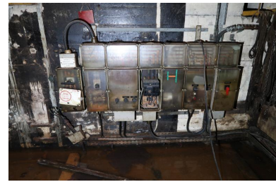
Vue des armoires électriques (n° 1). On peut lire : Sectionneur G[énéral] d'alimentation des chariots transbordeurs du slip, Pompe local treuil... et signalétique DÉFENSE D'ENCLANCHER Phot. Guillaume Lécueillier IVR53_20235605350NUCA
