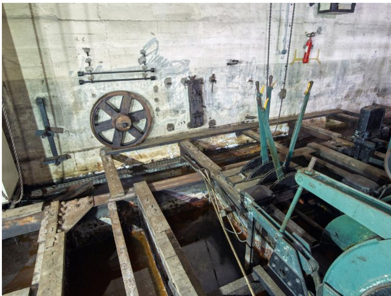
Vue des pièces de rechange et outils fixés au mur : roue dentée, clés et cric manuel. A droite, les leviers des commandes mécaniques du treuil
