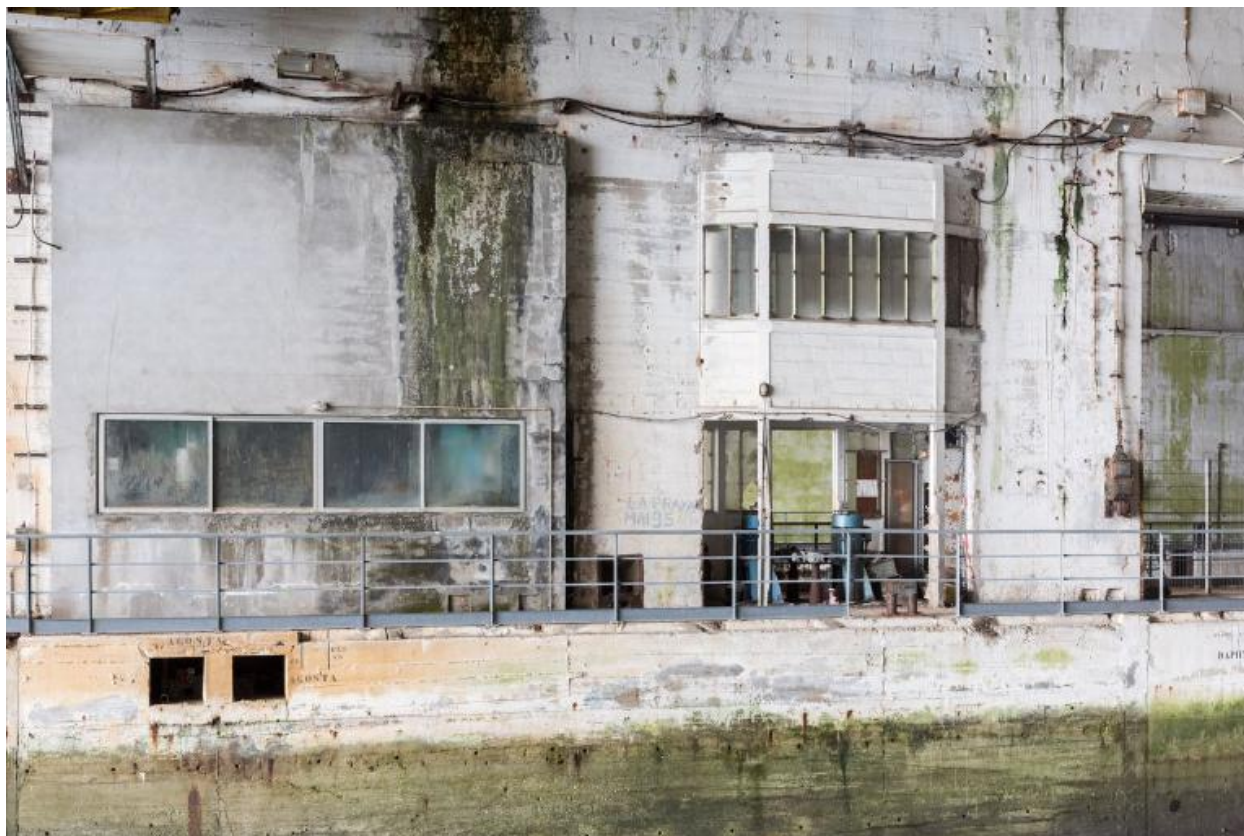
Vue de l'alvéole G (n° 13 et 14) : quai ouest n° 14, détail des équipements, emplacement des pompes des bassins F et G
