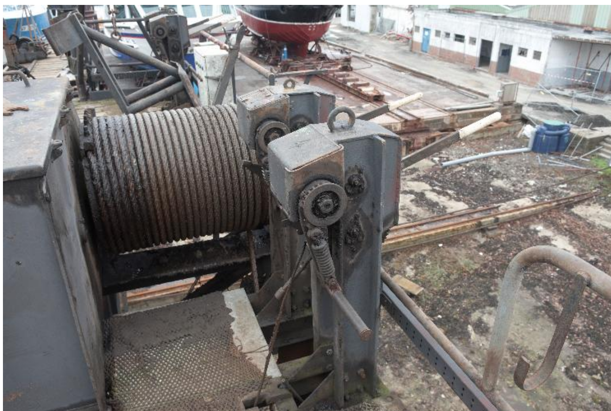
Passerelle : système mécanique, treuil
