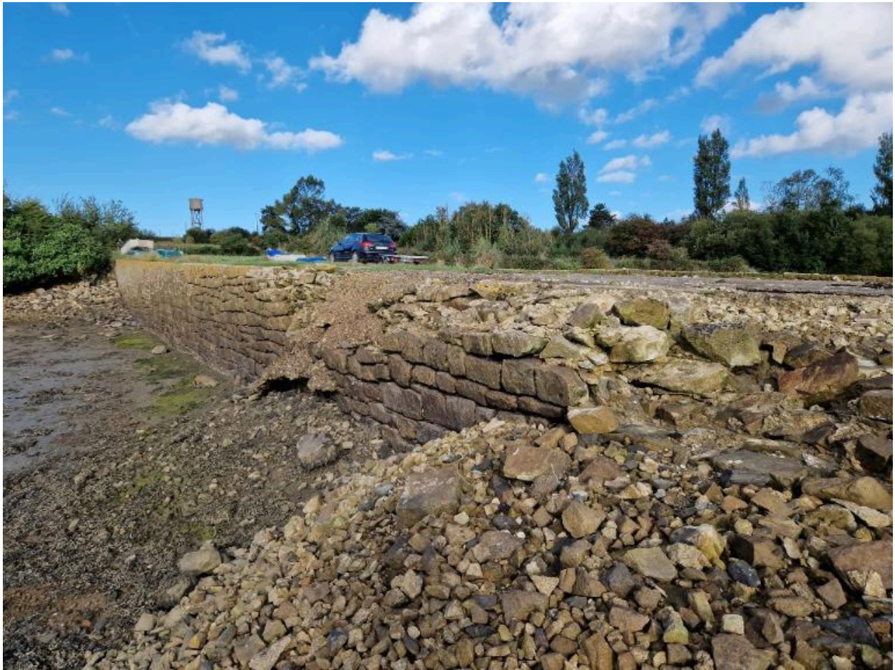
Vue de détail de l'élévation sud : dégradation de la maçonnerie de moellon de granite
