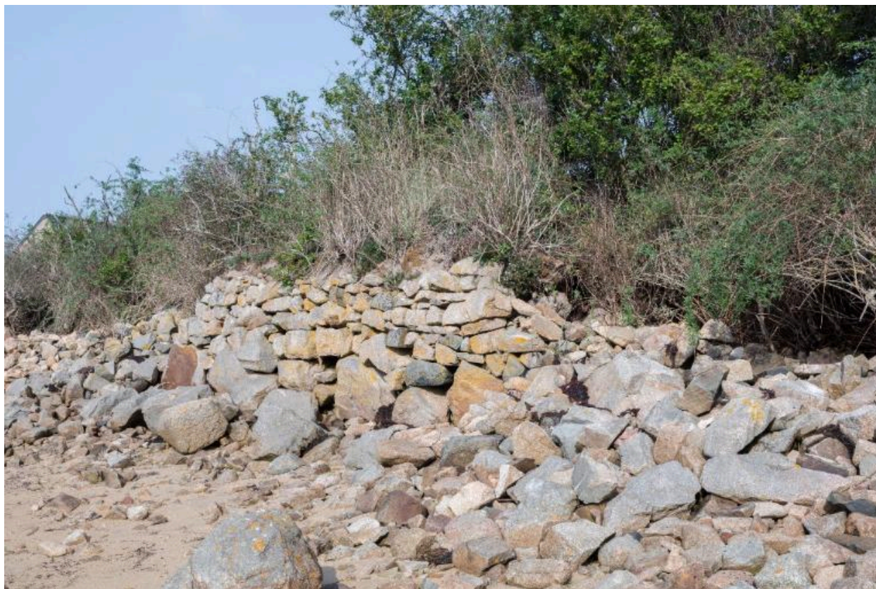
Mur de soutènement présentant des brèches, sur la rive est de l'anse de Pelinec
