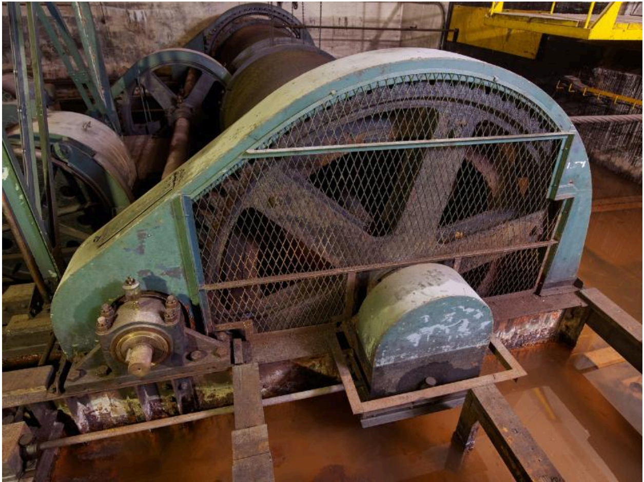
Vue des engrenages sous carter de protection des grands tambours pour les câbles de hissage du charriot du slipway. La salle est inondée (état en janvier 2023)
