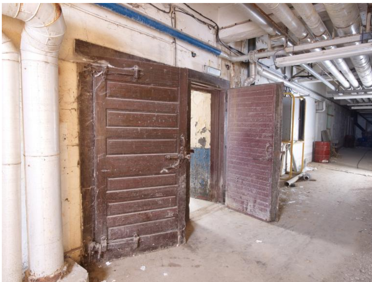
système de fermeture des chambres froides
