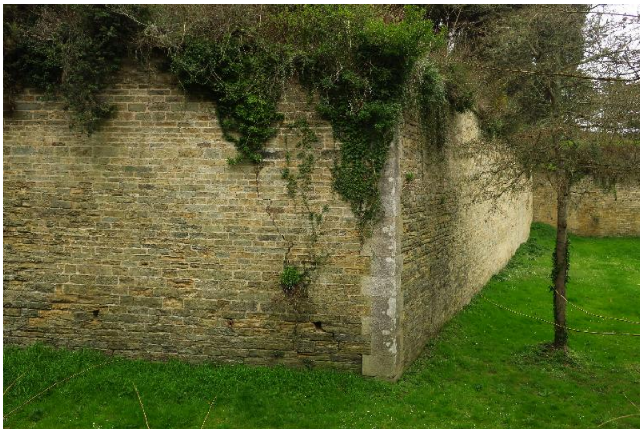
Le Palais, enceinte urbaine, bastion 21, angle du flanc et de la face gauche, dérangement dans la maçonnerie.
