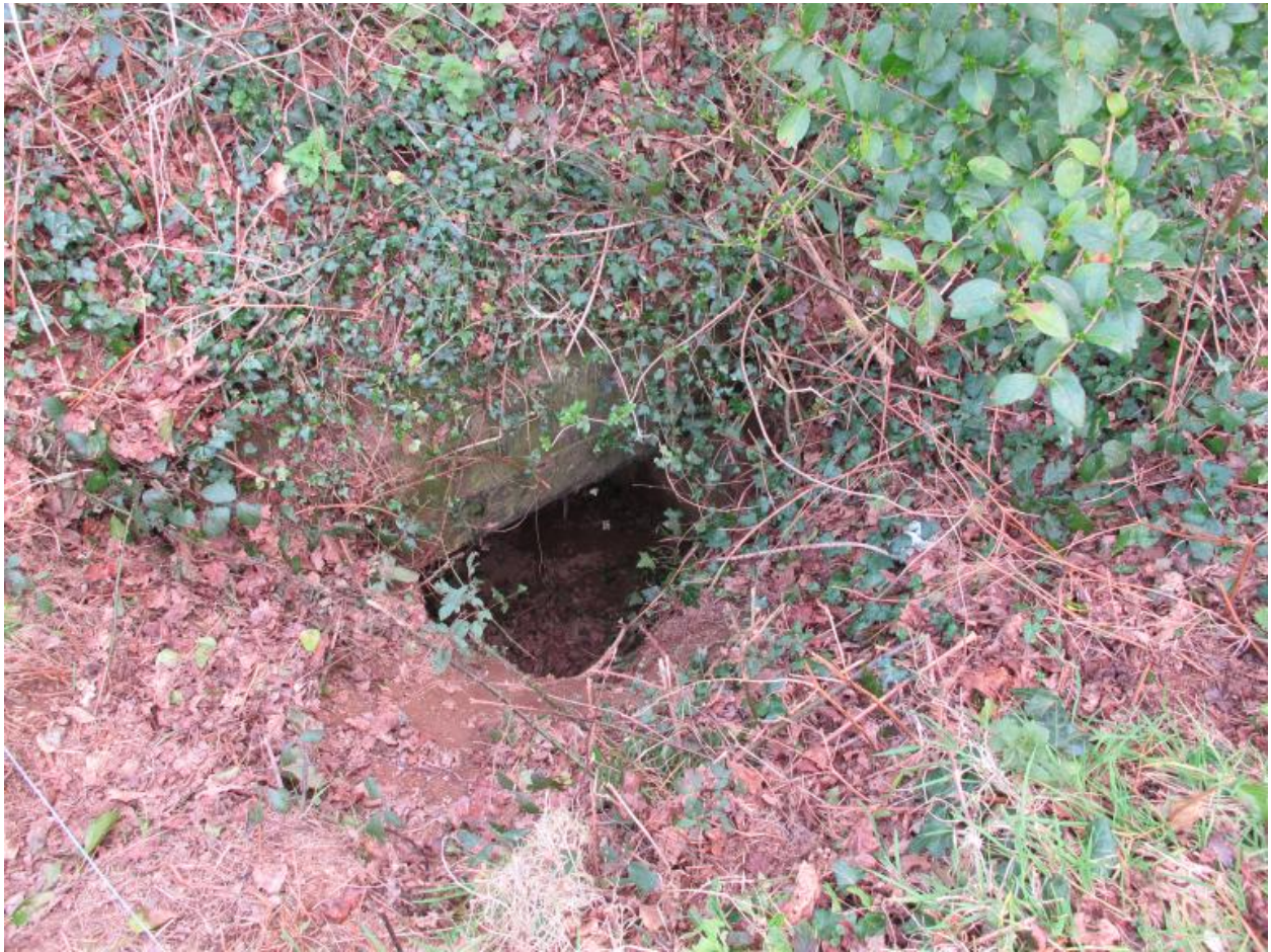
Vue de l'entrée ouest en partie remblayée et envahie par la végétation (état en 2013)
