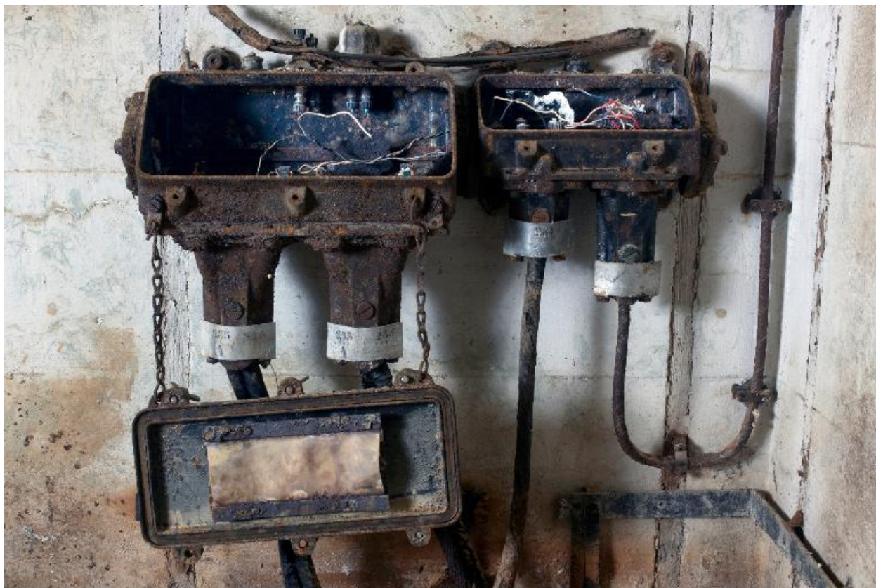
Vue du boîtier de connexion téléphonique : détail (lignes 285, 284, 283), photographie réalisée le 11 mai 2009
