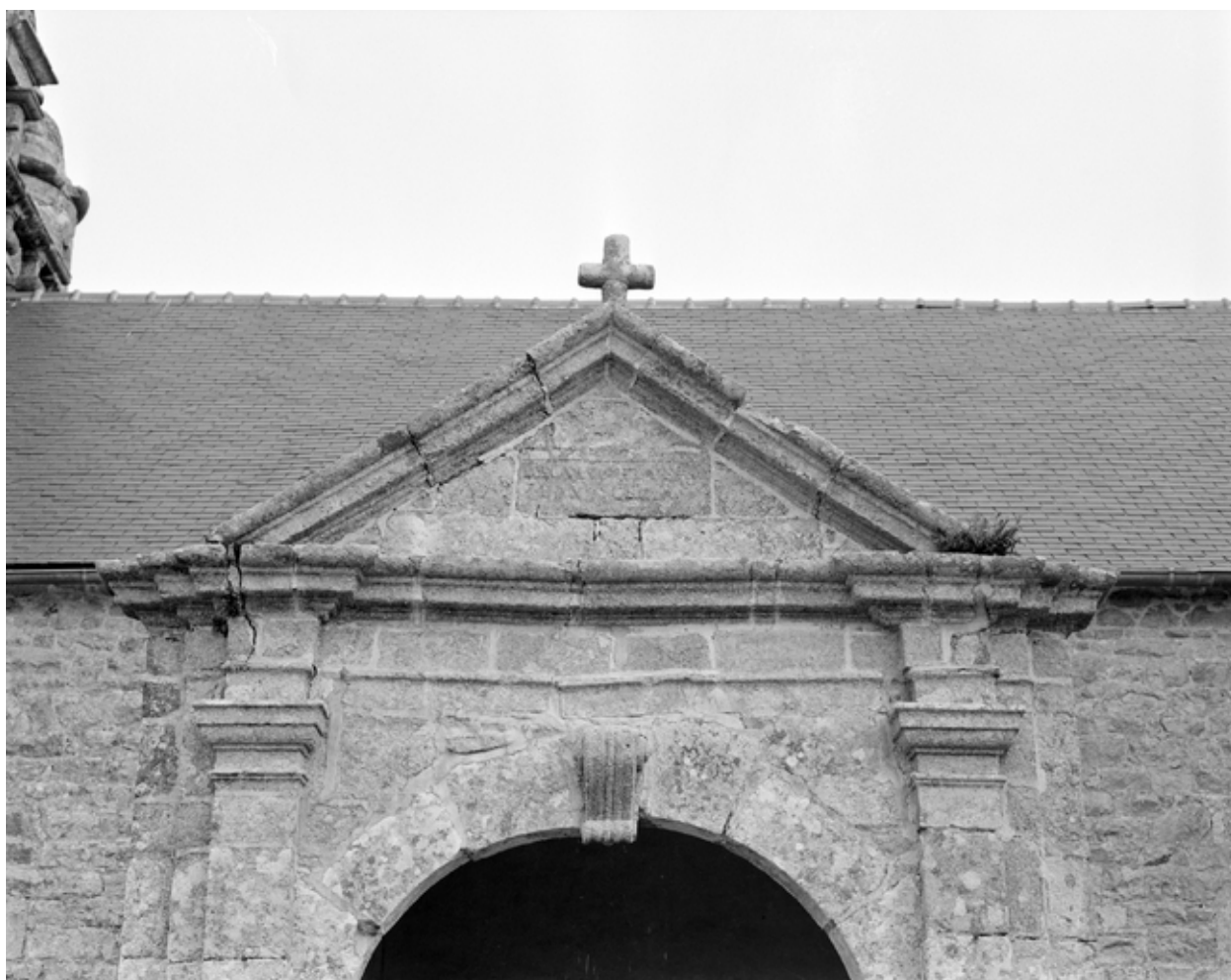
Détail du porche
