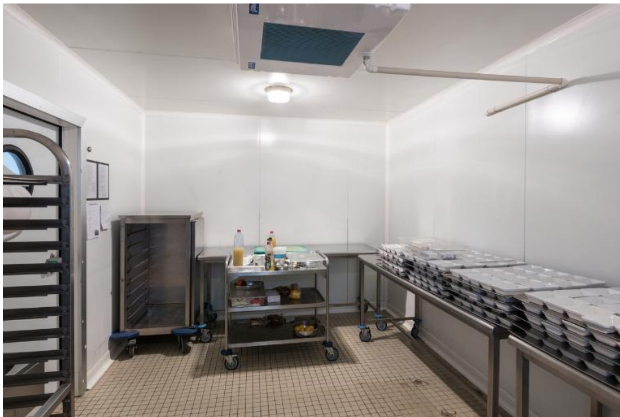
Intérieur d'une chambre froide.
