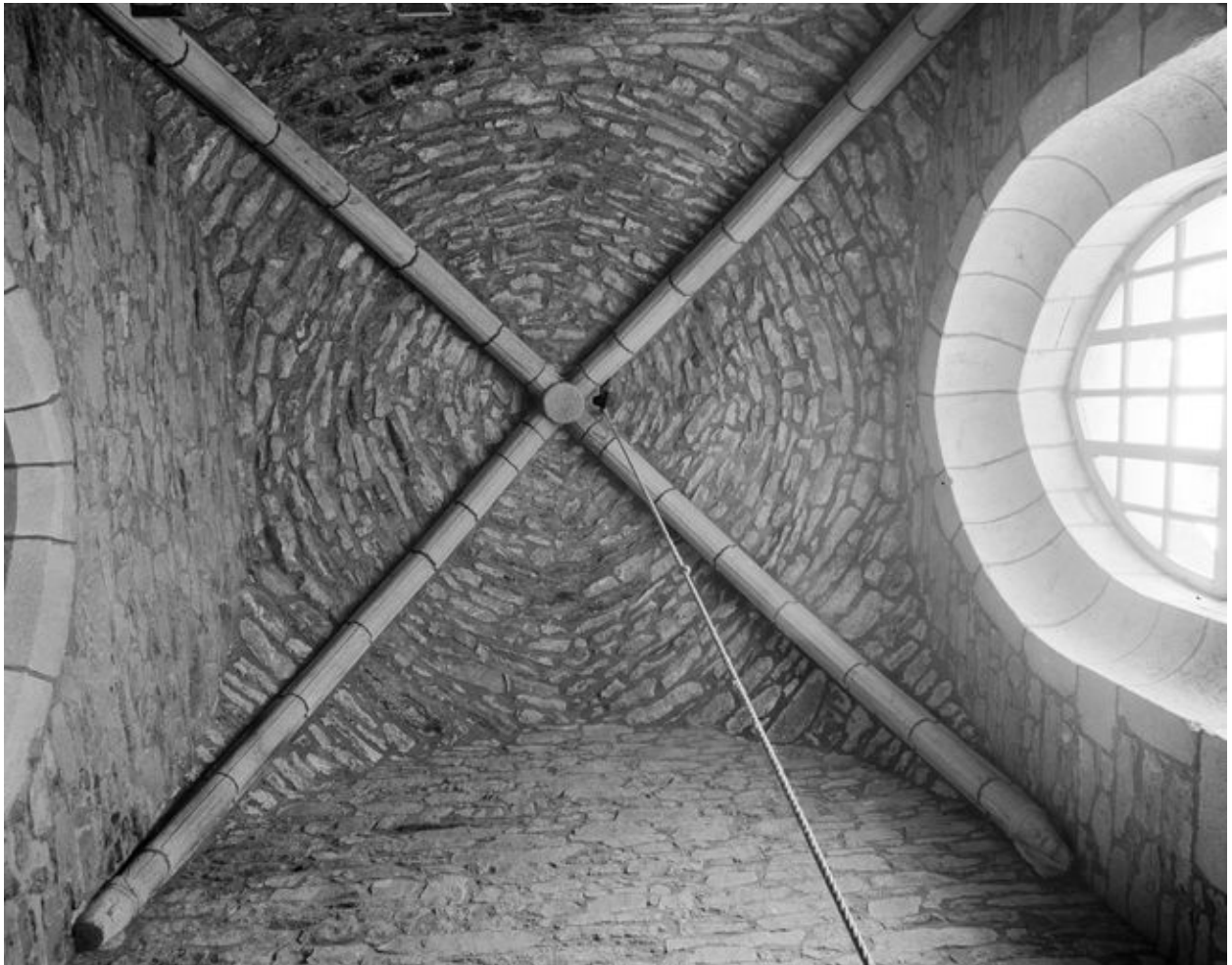
Chapelle, bras nord du transept : la voûte (état en 1992)
