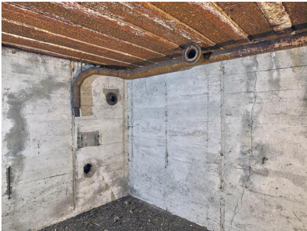
Vue intérieure : pièces de vie - chambre ouest avec la tuyauterie du système de ventilation. L'emplacement du ventilateur est bien visible sur le mur
