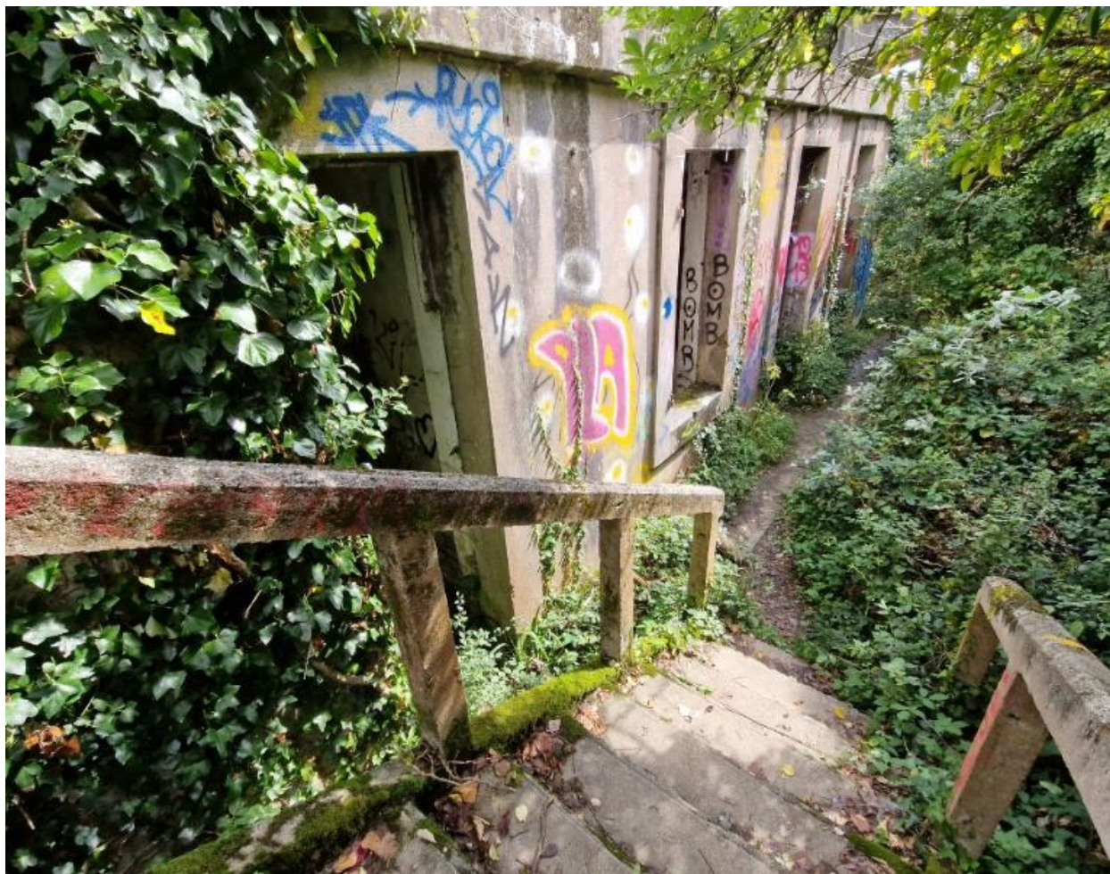
Vue de l'usine électrique du poste photo-électrique (état en 2024)
