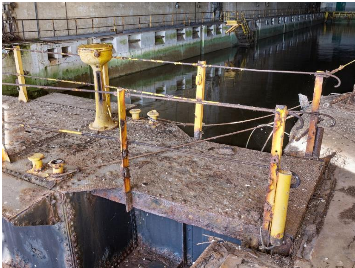
Vue de détail du bateau-porte fermant le bassin : commande de pompe. Elle fonctionnait avec une manivelle
