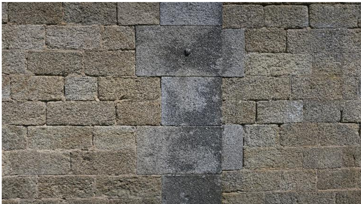
Hoedic, fort central, caserne à l'épreuve, détail de chaînage de la façade ouest.
