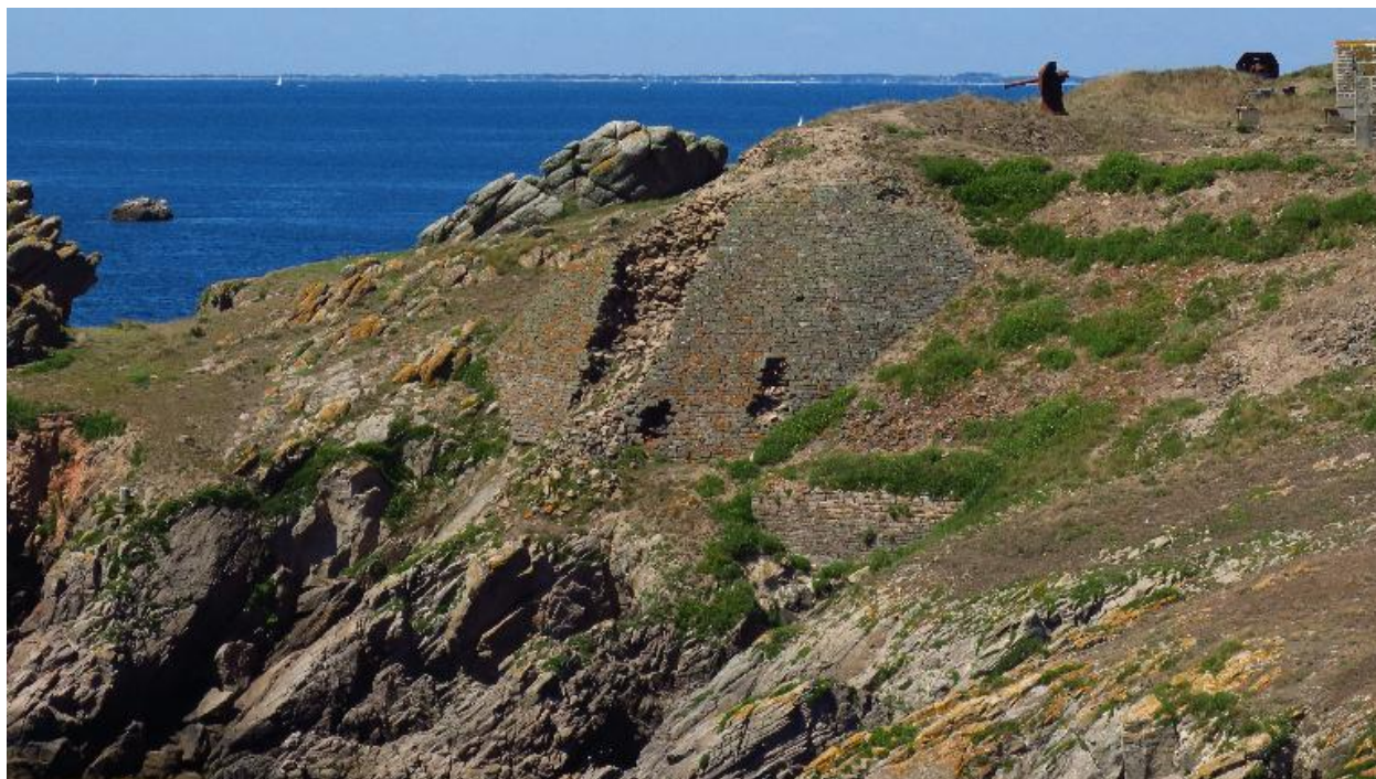
Île-d'Houat, batterie du Béniguet, mur de soutènement du parapet en voie d'effondrement.
