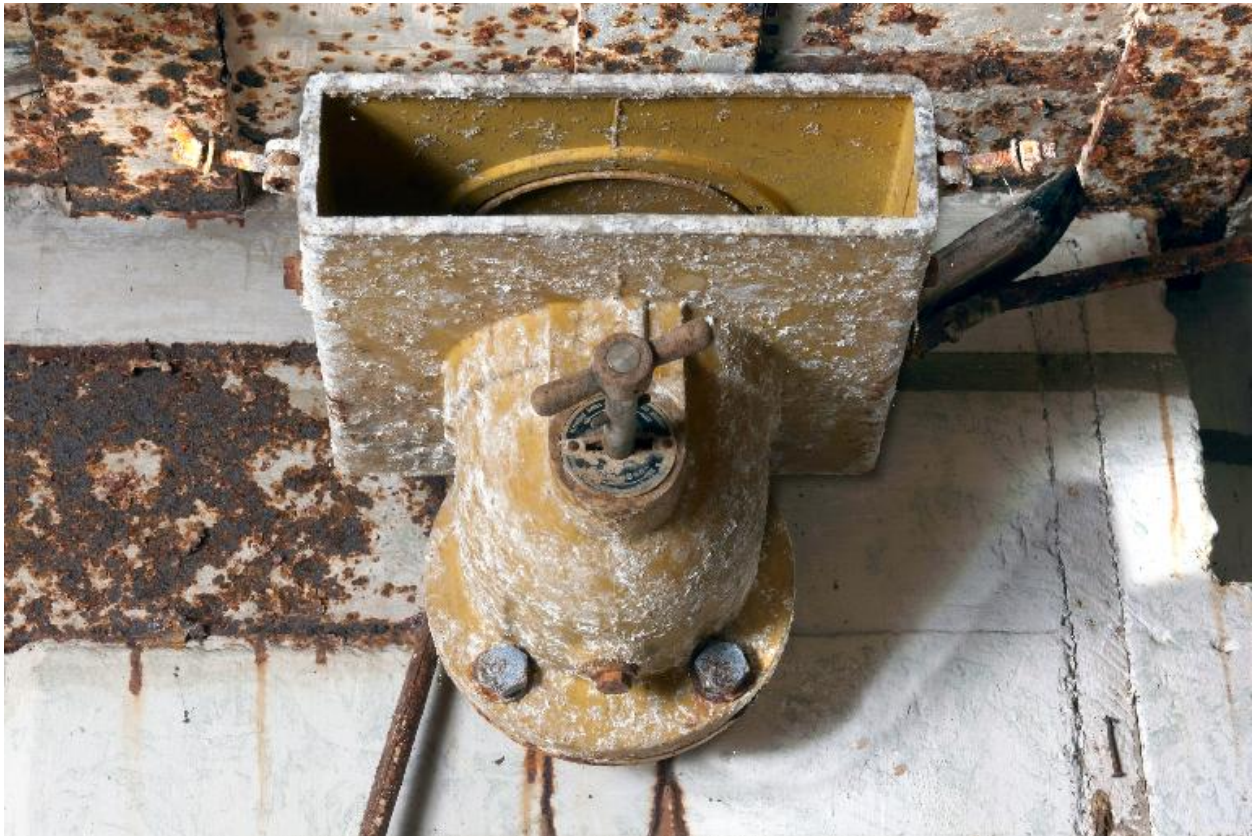
Vue du filtre dépoussiéreur avec sa plaque d'instruction, photographie réalisée le 11 mai 2009
