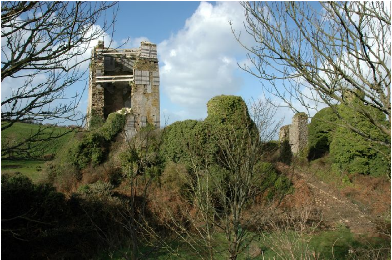
Vue générale du donjon (consolidation par étaieement mise en place en 2000)
