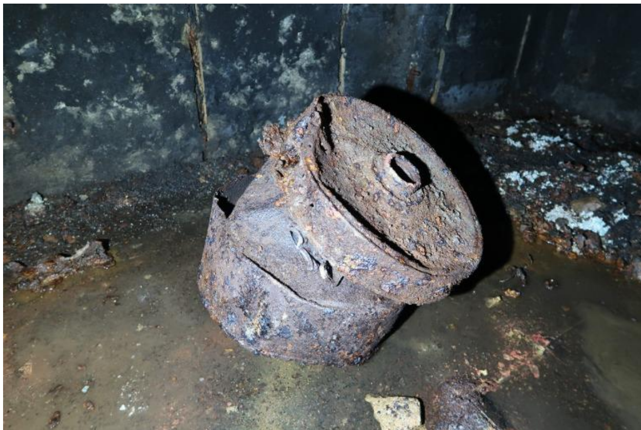
Vue de la salle de garde sud : au sol, baignant dans l'eau : filtre à charbon du ventilateur
