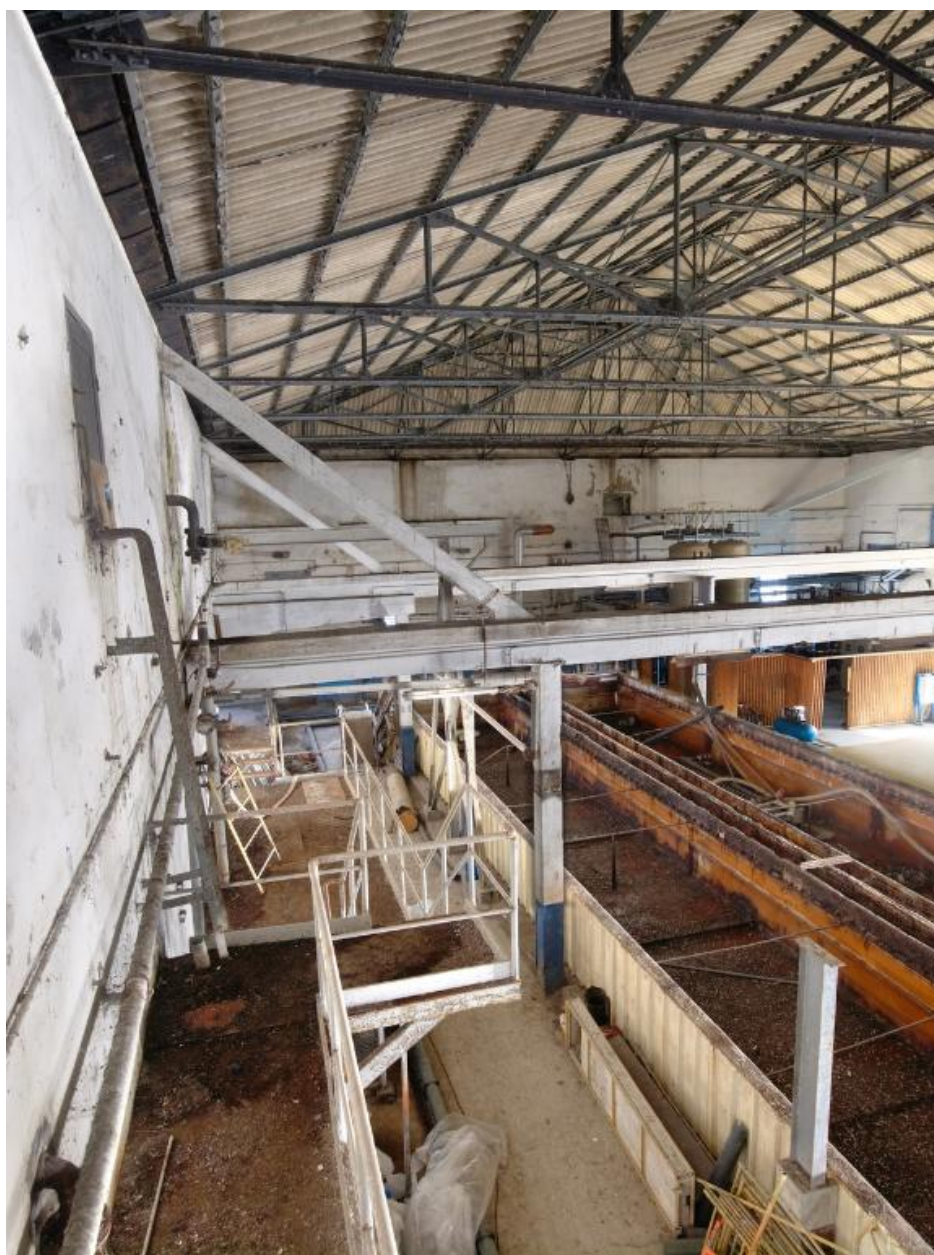
Frigorifique de Lorient : 4e étage, emplacement des générateurs et bacs de congélation
