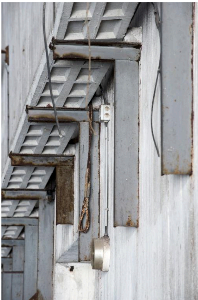
Vue de détail du chemin de câble
