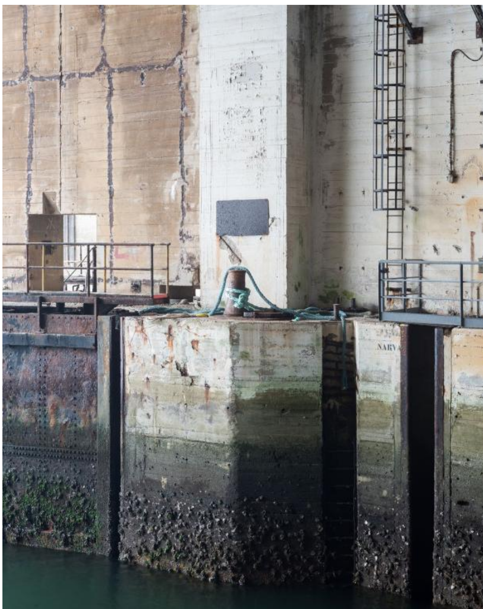
Vue de l'alvéole G (n° 13 et 14) : quai ouest n° 14, détail des équipements
