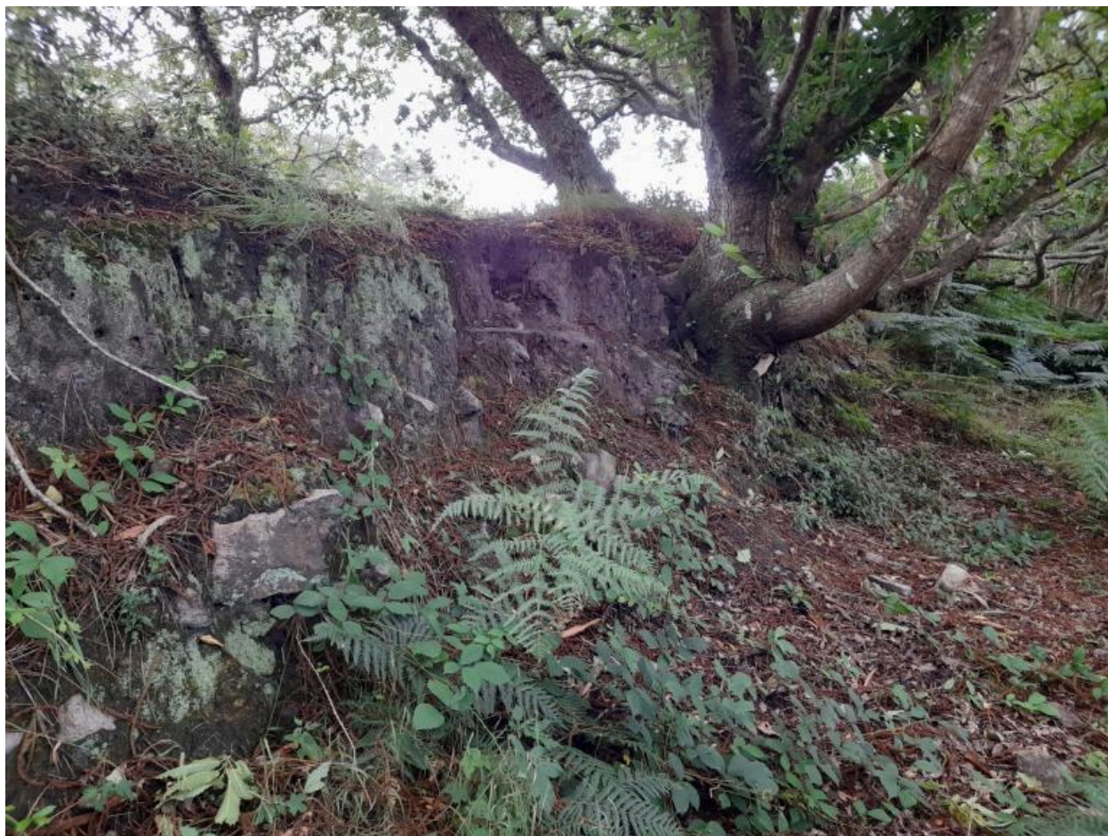
Mur 4 côté ouest. Parement détruit ?
