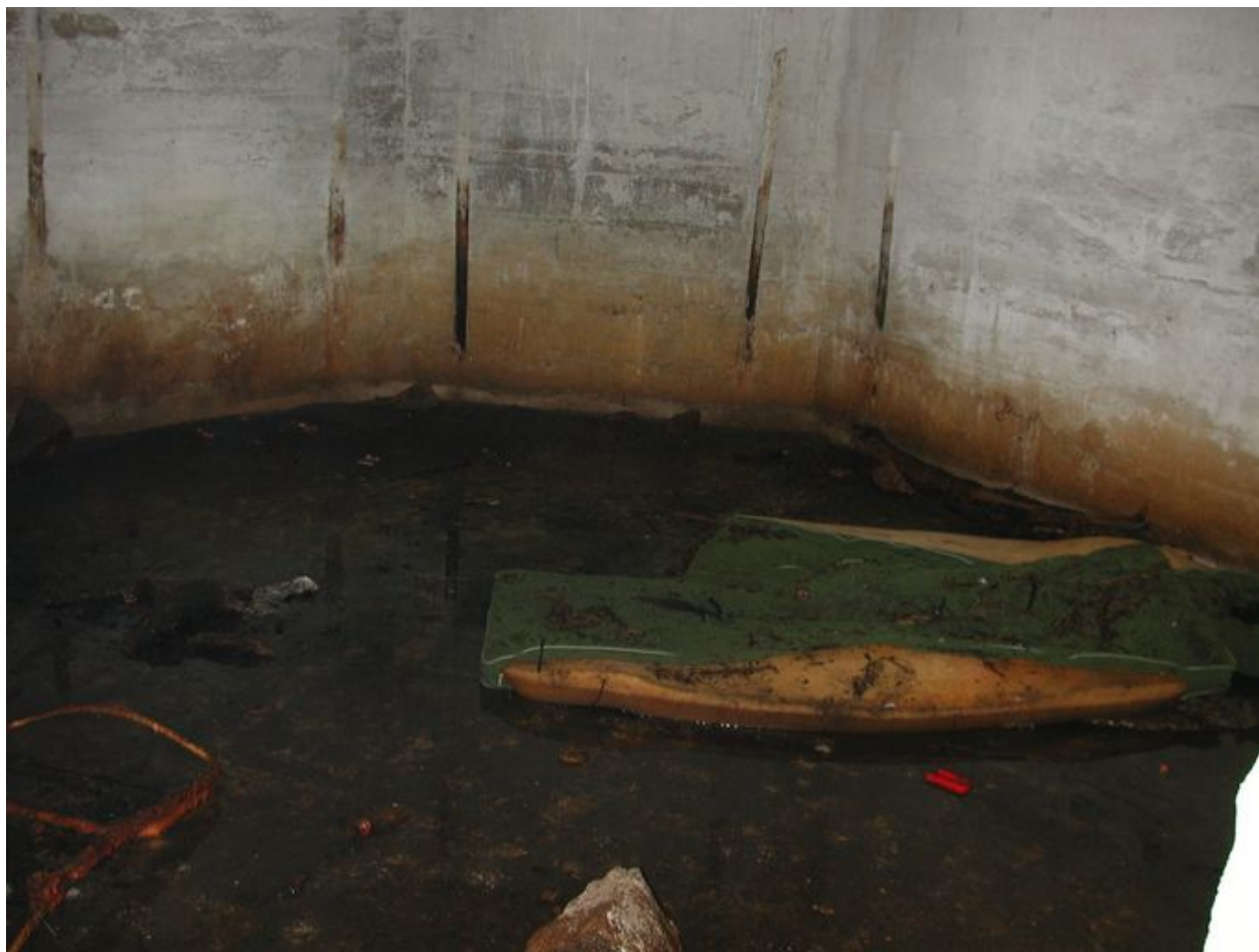
Vue intérieure (état en 2002). Le bunker est partiellement inondé
