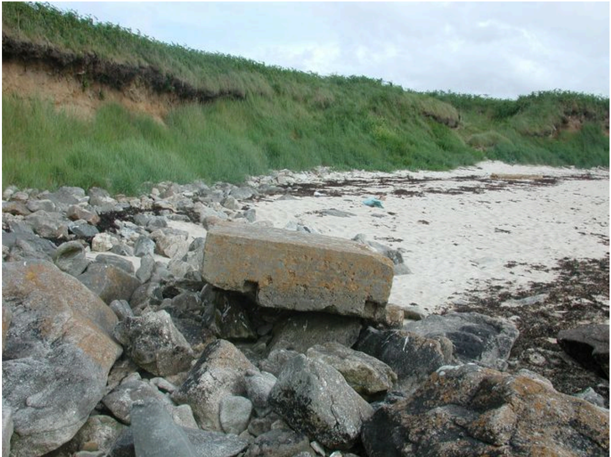
Vue de détail : bloc de béton projeté sur les rochers de la grève ? (état en 2002)
