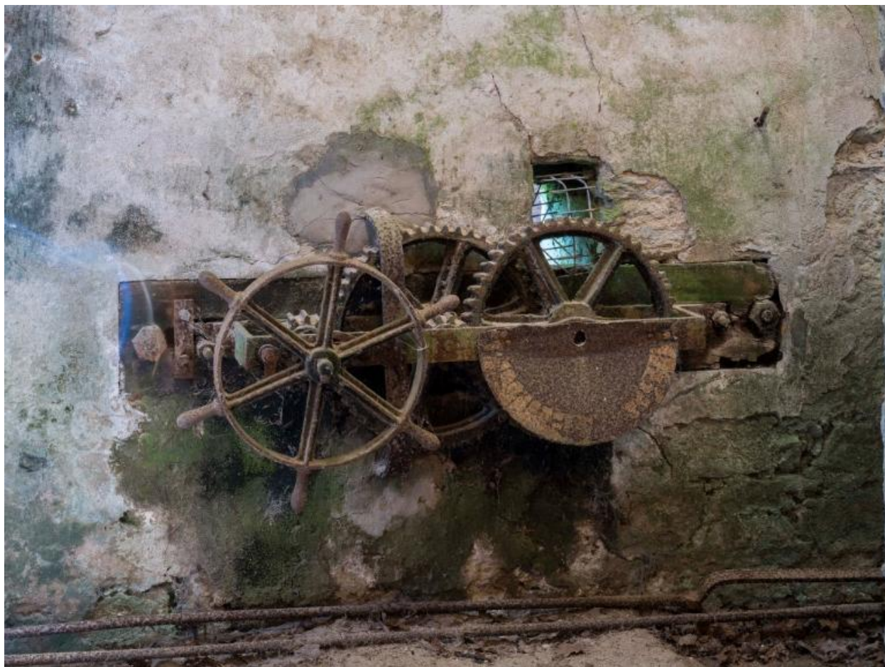
Bâtiment principal. Salle 1. Mécanisme à actionner la vanne
