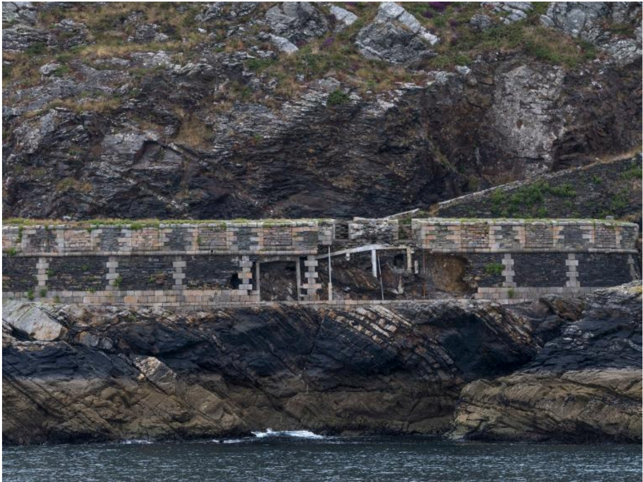
Vue depuis la mer : brèche ouest (état en 2025)
