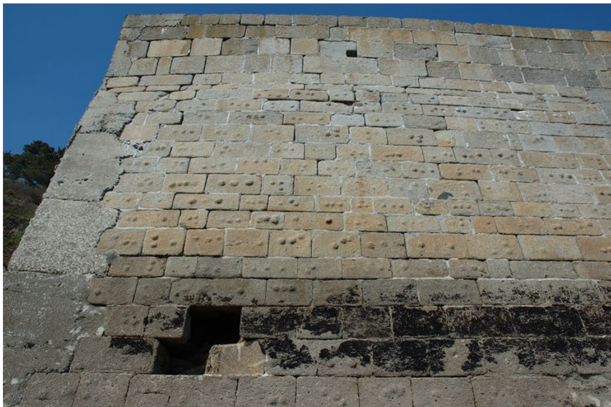
Vue de la batterie basse du Mengant : extrémité ouest ruinée
