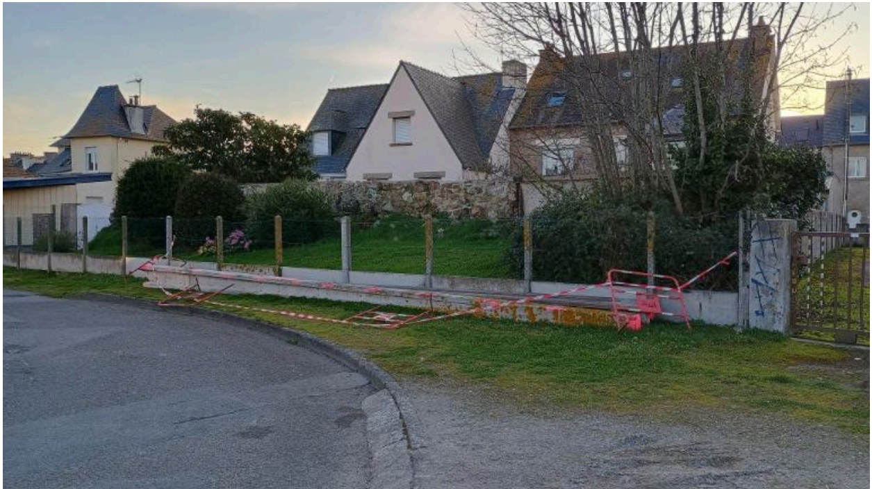
32 Vue des vestiges de la digue dans la parcelle section CA, n° 571 depuis la rue Claude Bernard à l'est
