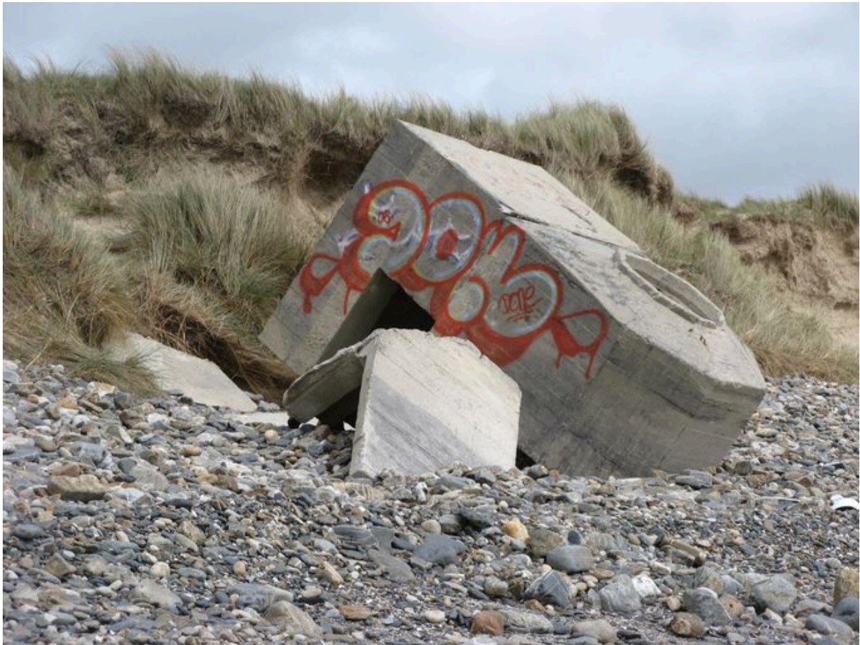
Abri sur la plage de l'Aber, basculé en raison de l'érosion côtière
