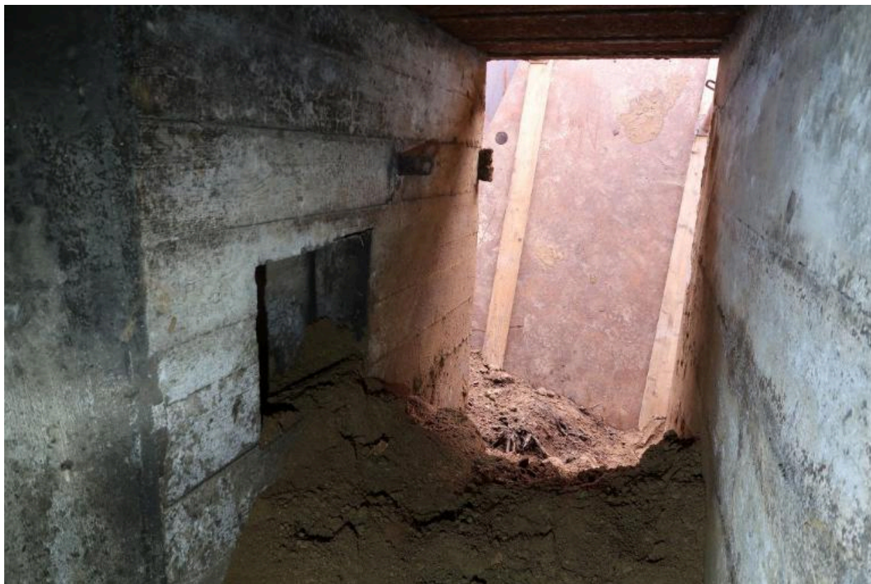
Vue de l'entrée sud. A gauche, niche murale avec passage de câble
